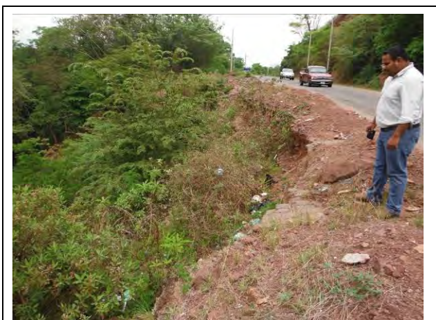
Foto 4.4.1: Escarpa del deslizamiento, Ruta de la Carretera Nacional CA-6 (Sta. 63+000) Vista del costado Nicaragua.
