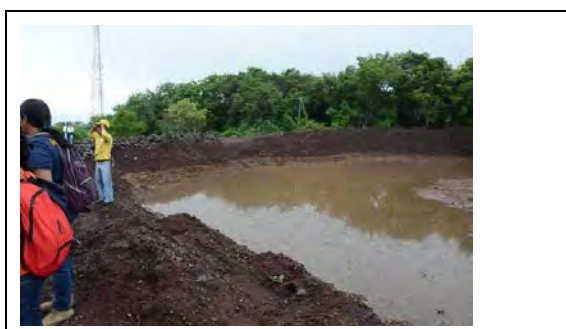
Foto 4.2.12: Cuenca retardante de sedimentación construido por el gobierno de El Salvador Fuente: Misión de estudio
