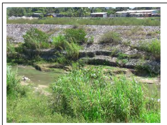
Gráfica 4.4.11: Obras de protección de orillas que recibieron grandes daños (Curso inferior aprox. A 100m del puente férreo)
