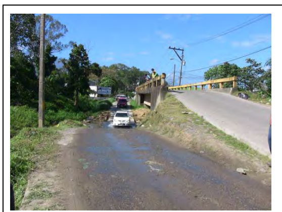
Foto 4.4.18: Puente del río Adan (Ciudad Ceiba) gestionado por la municipalidad, Tiene alta circulación, sin embargo el primer carril es puente sumergido
