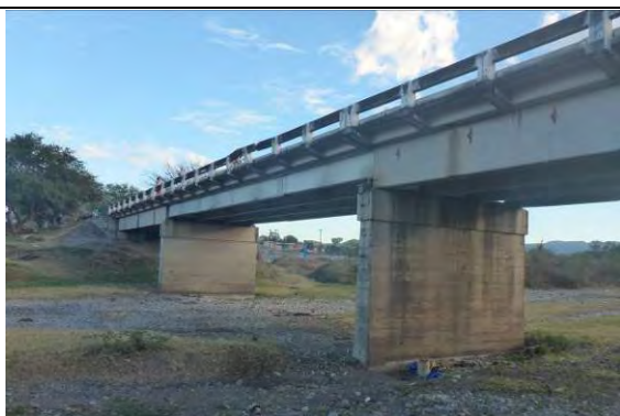
Foto 4.3.11: Puentes Las Chanillas, No se confirmaron avances en erosiones (Feb. 26, 2015)
