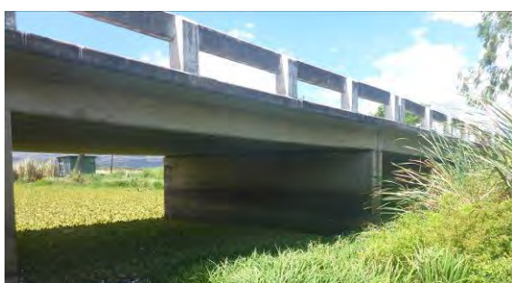
Foto 4.2.7: Puente Junquillal, No se confirmaron avances de erosiones (Feb. 26, 2015)
