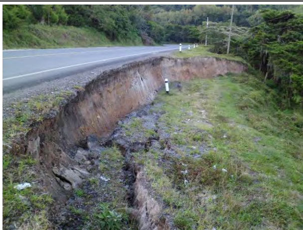
写真 N4.1: 地すべり頭部の状況、幅 70m に亘り陥没している。FOMAV より受領(撮影日不明)
