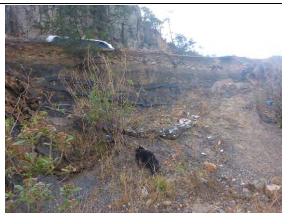
写真 H4. 3：補強土の崩壊 ジオテキスタイルが露出し、一部は破損している。(2015/2/23)
