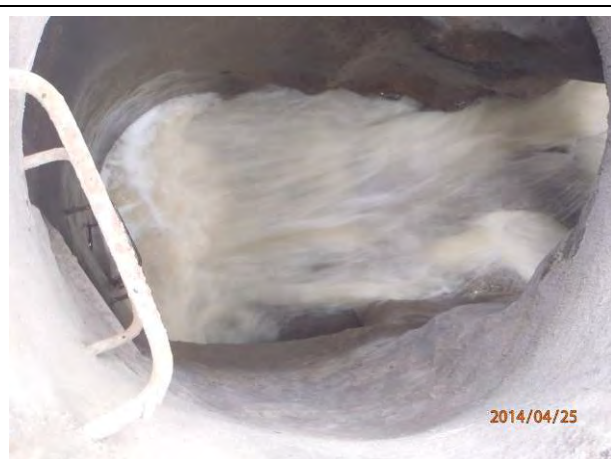
写真 E7. 5: 管勾配は急で降雨時の管内はかなり激しい水流となり管壁に影響する。(2014/4/25)
