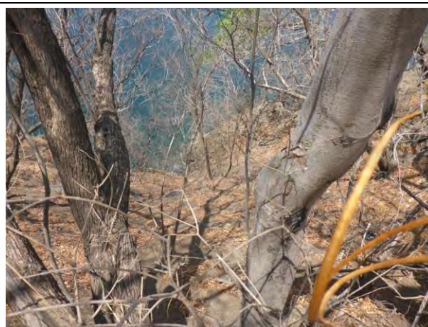
写真 N6. 4: 道路谷側斜面 崩壊跡が確認できる。(2015/3/13)
