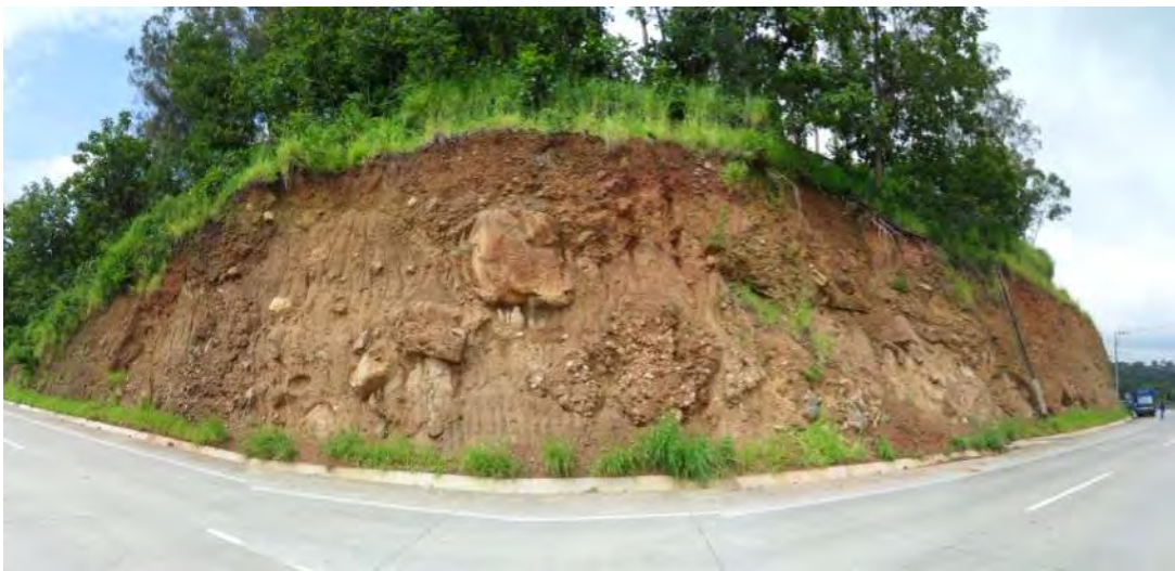
写真 E5. 15： 大きな岩塊も斜面に認められる。表層は非常に不安定である。
