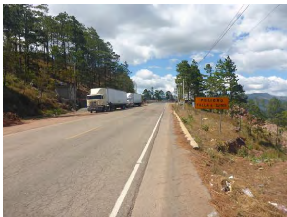
写真 H1.3: 道路面の状況 路面が沈下しており、車両が徐行して通過している。(2015/3/6)
