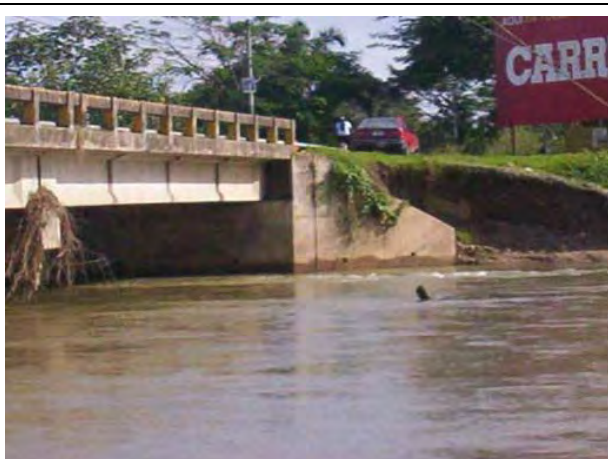
写真 H8.3: トコア橋 洪水時の橋台（トコア側）の洗堀状況。2009 年には橋台背面が崩壊した。
