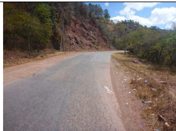
写真 H1.3：終点側の状況 起点側より撮影 道路延長 80m に亘り路面が沈下している。(2015/3/6)
