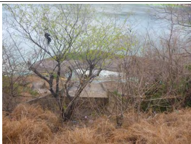
N5.5: アウトレットの状況 ゴミ、ヘドロが堆積している。(2015/3/13)
