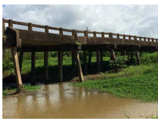
写真 H5. 4: アリビオ・デル・アグアン No. 4 橋 橋脚が沈下している状況。橋桁が沈下により凹に屈折している。
