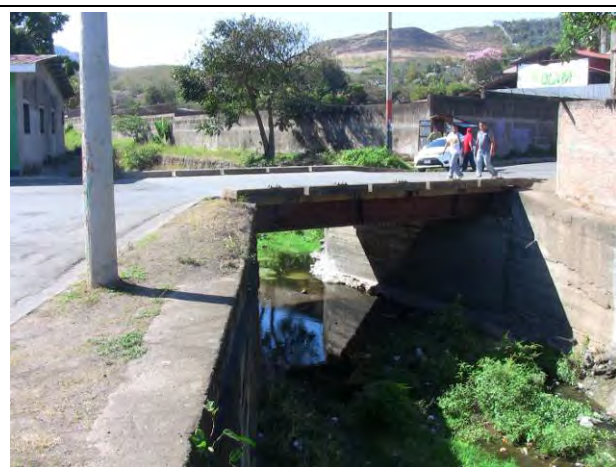
写真 N8. 5: Grande 川右支川 Mala 川の橋梁、狭窄部となっており、洪水が氾濫、越流する。
