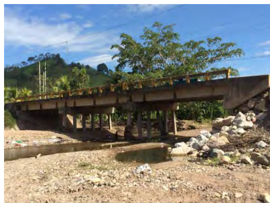
写真 H7.2: ペリス橋 サバ側橋台の損壊状況、巨石により護岸している。
