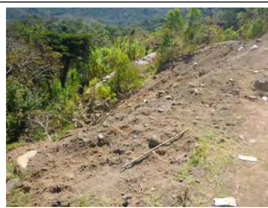
写真 N4.6: 道路側部に作られたコンクリート擁壁 地すべり活動により被災している。(2015/3/16)
