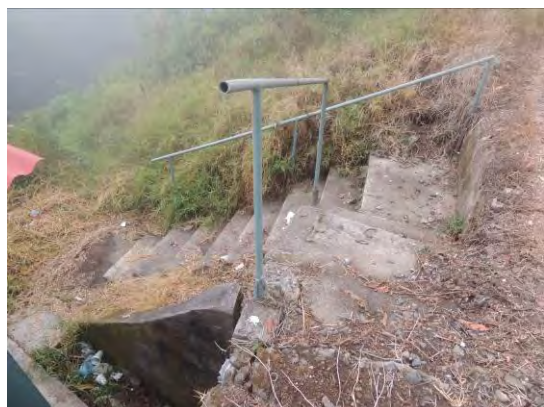
写真 E1.1: ラス・ラハス 溪流源頭部。急斜面のクリープ(1年間に1cm未満の地盤移動)による亀裂の発生が認められる。(2015/ 4/15)
