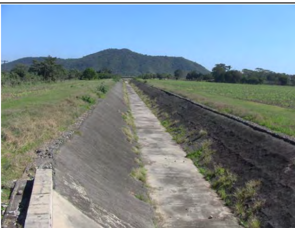
写真 H9.3: チョテペ水路、水路の状態は良いが、CCIVS が期待した機能を十分に発揮していない。
