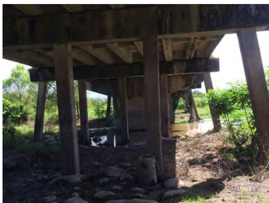
写真 H5. 3: アリビオ・デル・アグアン No. 4 橋 カスティージャ港側橋脚の状況。一部パイルベントが洗堀により沈下傾向にある。支柱が不安定。
