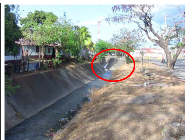
写真 N7.4: Oriental Canal 中流湾曲部：フラッシュフラッドが市道へ溢水する。
