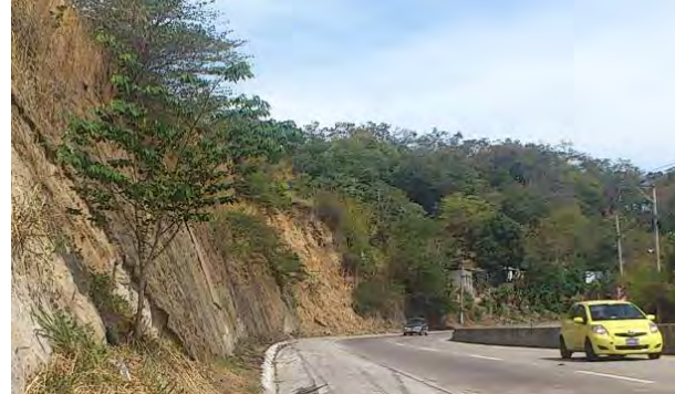
写真 E5.12: 斜面7 下り路線側斜面 (斜面高最高 17m、平均斜面高 15m、斜面道路脇延長 75m) 軟岩～風化土斜面、軟岩部は概ね安定しているが風化土部で崩壊が進行しつつある、距離表 18km+500m (2015/3/14)
