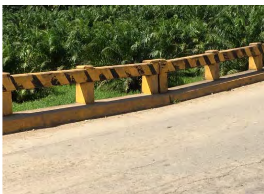
写真 H5. 5: アリビオ・デル・アグアン No. 4 橋 高欄、路面が沈下により凹に屈折している。
