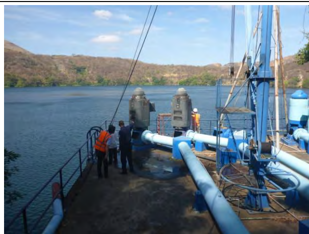
写真 N3. 4: 保全対象のポンプと給水管 (2015/3/13)
