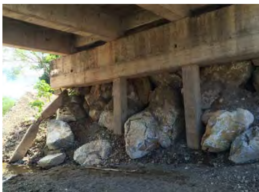
写真 H7.3: ペリス橋 橋台の杭が損壊し、流出している。巨石により橋台背面を抑えているが解決策となっていない。
