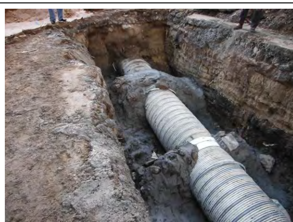
写真 E7. 6: 排水管の交換工事も十分な品質を確保しているとは言えない。(2012/10)
