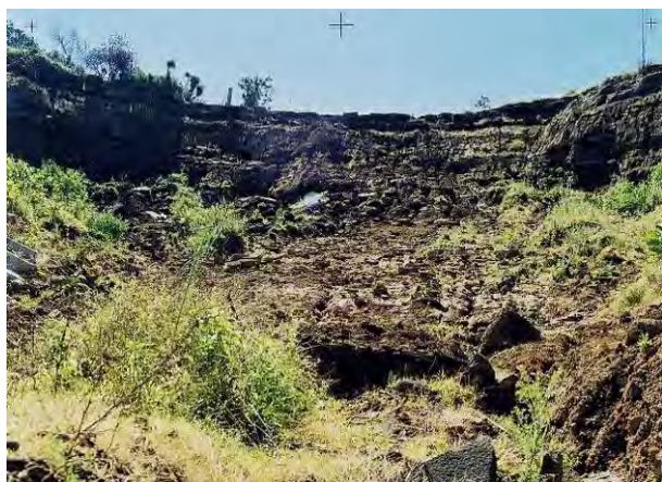
写真 E2. 3: 地すべり頭部の状況 写真提供 福岡教授
