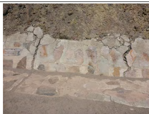
写真 N1.6: 小段に認められる亀裂 (2015/3/16)
