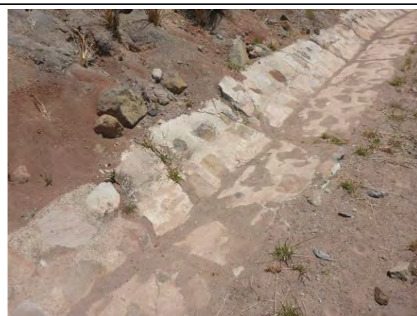
写真 N1. 8 : 小段に認められる亀裂 (2015/3/16)
