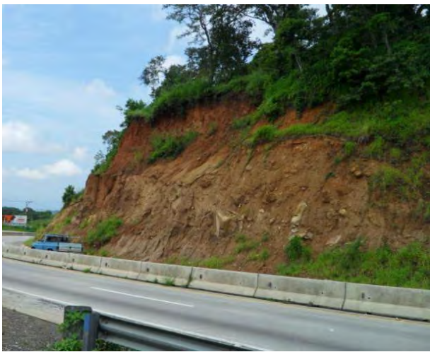
写真 E5. 13： 上部斜面はオーバーハングし、斜面中腹にも不安定な土砂が分布する。
