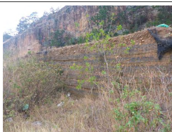
写真 H4. 5：補強土の被災状況 (2015/2/23)
