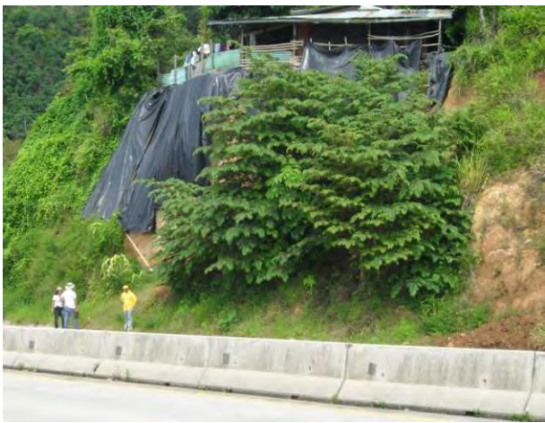
写真 E5. 14： 斜面で崩壊が発生し、応急対策工として黒いシートを敷設している。
