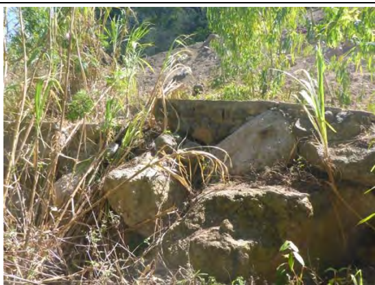
写真 N4.5 道路側部に作られたコンクリート擁壁 地すべり活動により被災している。(2015/3/16)
