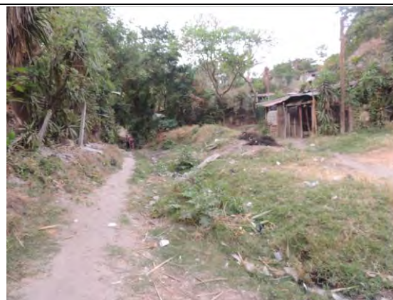
写真 E1. 8: 75 アベニダ・ノルテ道路から 50m 上流側。水路断面は明らかに不足していると判断される。(2015/4/14)
