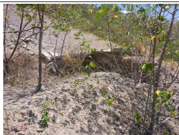
写真 N1. 12 : 水路のずれ下から 4 段目(2015/3/16)
