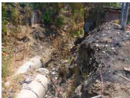
写真 E1.13: 75 アベニダ・ノルテ道路 と ブレバル・コンスティトゥション道路間、カーレ・プリンシパル道路沿い。水路の状況 暗渠構造となっている。維持管理が不十分である。
