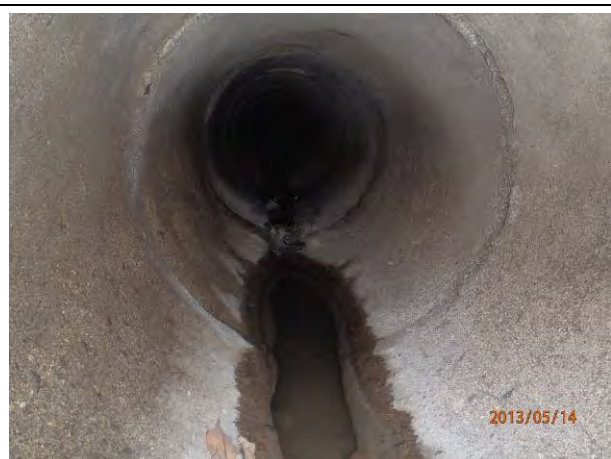
写真 E7. 3: 陥没地点付近の管路状況、管底部が浸食され穴があいている。(2013/5/14)
