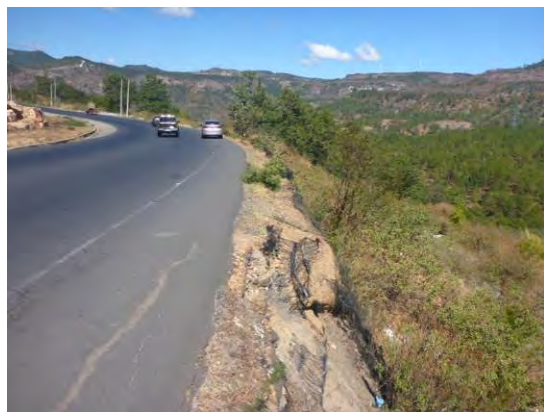
写真 H4. 1：道路谷側 補強土が崩壊している。補強土の高さは5～10m 程度である。被災延長は200m である。(2015/2/23)
