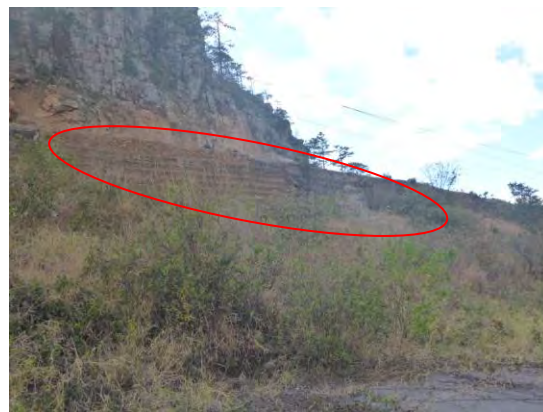
写真 H4. 2：補強土の崩壊 遠景 過去の迂回路があり迂回路は谷側に移動している。(2015/2/23)
