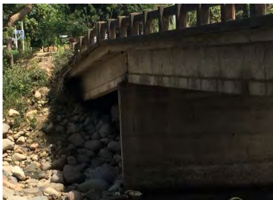
写真 H6. 3: タウヒカ橋 橋台から桁が落橋している状況。全面を巨石により護岸しているが、それにより河川断面を減少させている。
