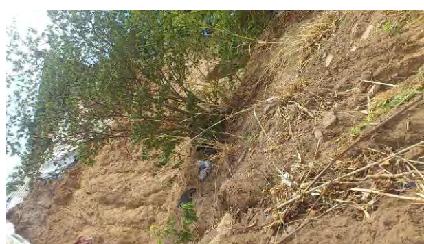
写真 E5.11: 斜面6 浸食防止に防水シートが掛けてあるがすでに劣化している (2015/3/14)
