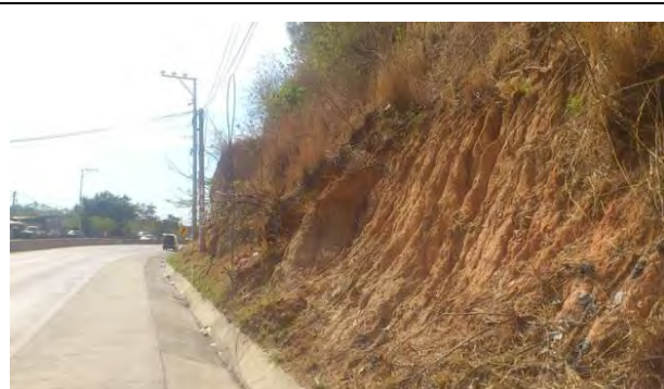
写真 E5.7: 斜面4 浸食されやすい風化火砕流堆積物 (2015/3/14)
