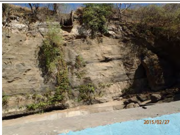
N5.3: 崩壊地 崩壊地下方より撮影 (2015/2/27)
