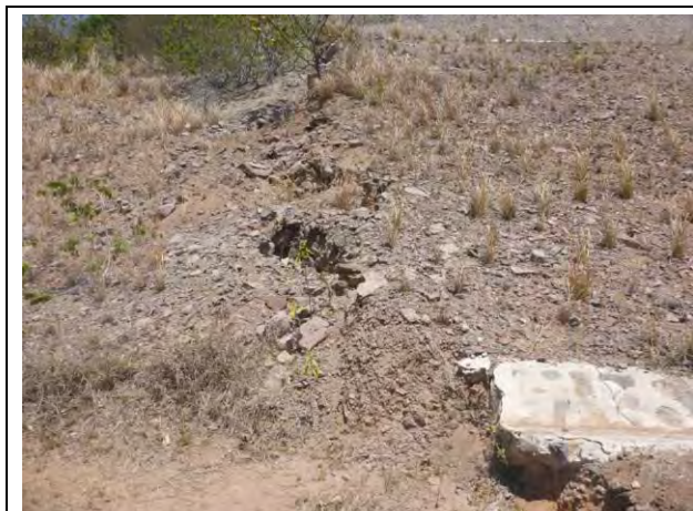
写真 N1. 11: 地すべり右縁部の亀裂(2015/3/16)
