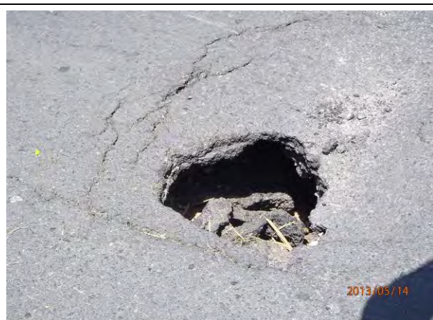
写真 E7. 1: エスカロン地区 89 北通りでの地下空洞の天井部の陥没。(2013/5/14)
