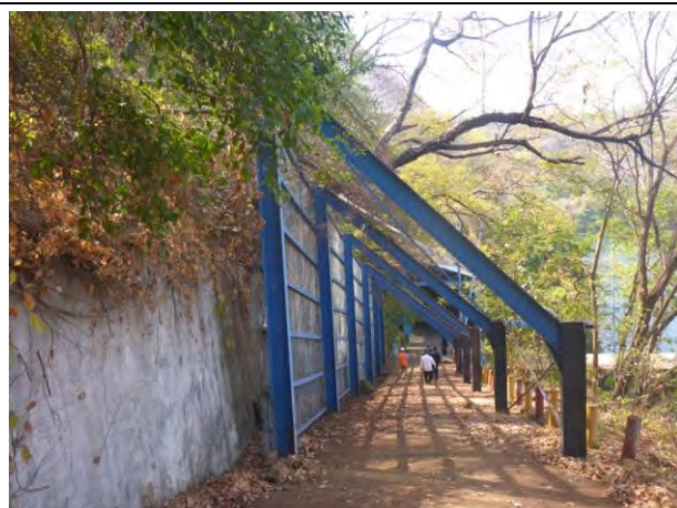
写真 N3. 2: 水管理局によって設置された落石防護柵 (2015/3/13)
