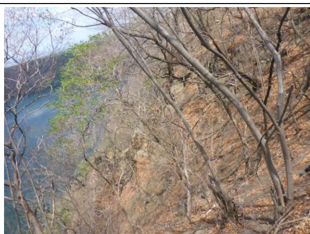
写真 N6. 5: 道路谷側斜面 崩壊跡が確認できる。(2015/3/13)
