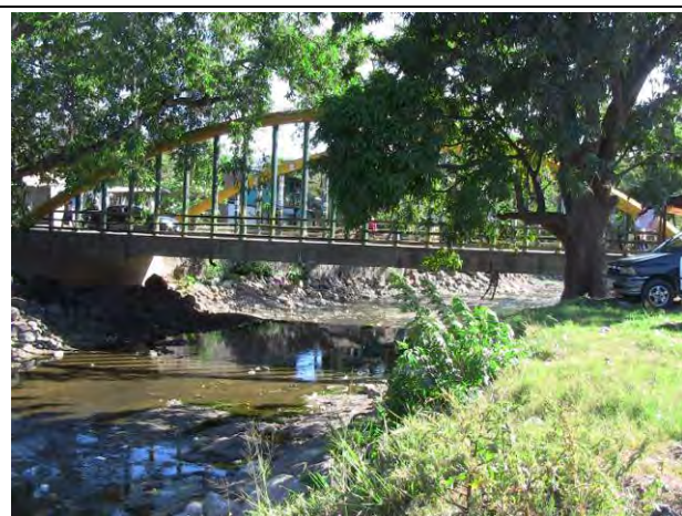
写真 N8. 3: Grande 川沿いの家屋：2014 年に流失被害。
