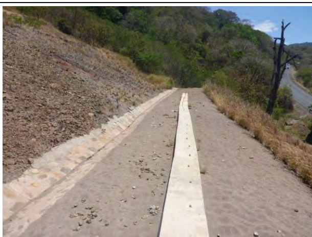
写真 N1.3: マイクロパイルの施工箇所 L=17m 谷側への押し出しが認められる (2015/3/16)
