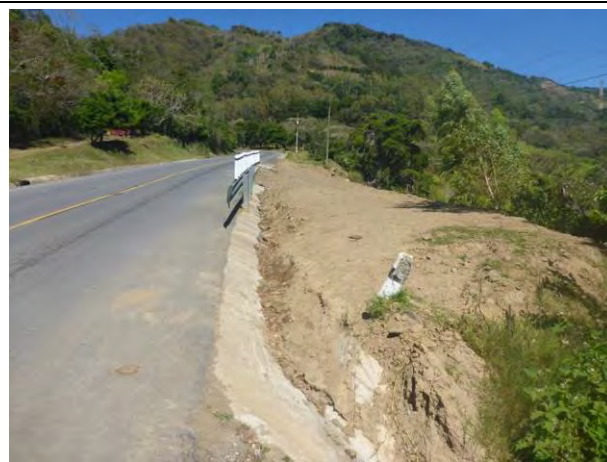
写真 N4.2 地すべりの頭部状況 FOMAV による応急対策が実施されている。雨季になるともった土が沈下し、下方に流されているとのこと。(2015/3/16)
