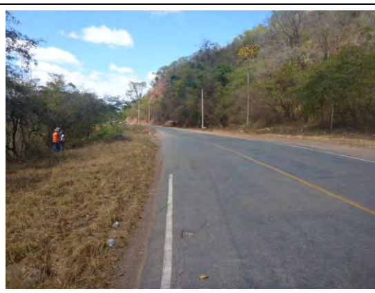
写真 H1.4：終点側の状況 終点側より撮影 道路延長 80m に亘り路面が沈下している。(2015/3/6)
