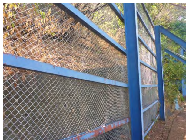
写真 N3. 3: 落石によって網が変形している。 (2015/3/13)
