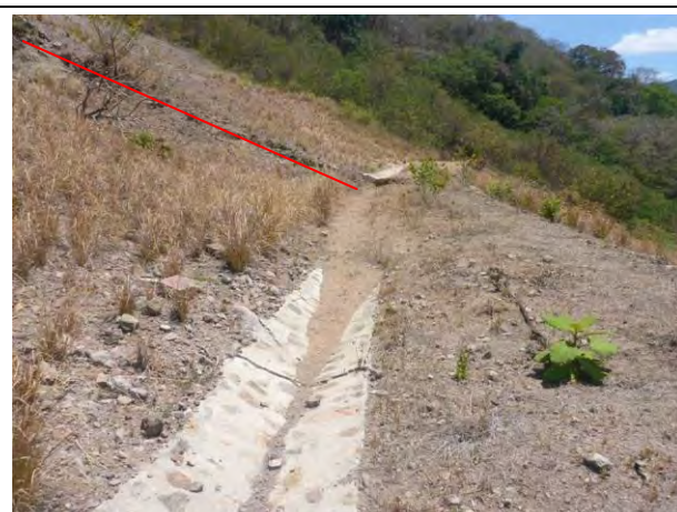
写真 N1. 10 : 水路のずれ 下から 3 段目 (赤い線が地すべり右縁部) (2015/3/16)
