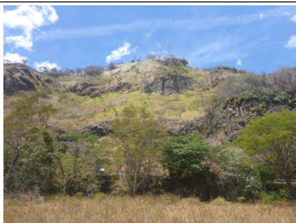
写真 N2.1：全景 斜面高 200m の斜面が 300m に亘り連続する。不安定な土砂、岩塊が斜面中腹に残存する。(2015/3/16)
