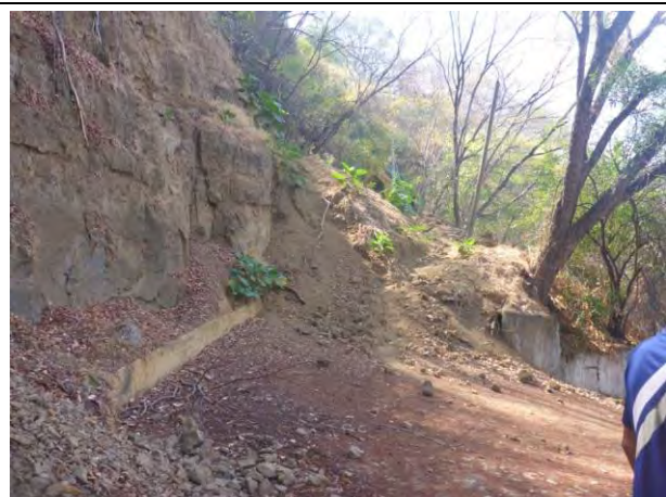
写真 N3. 1: 管理用道路を崩壊土砂が覆っている。 (2015/3/13)
