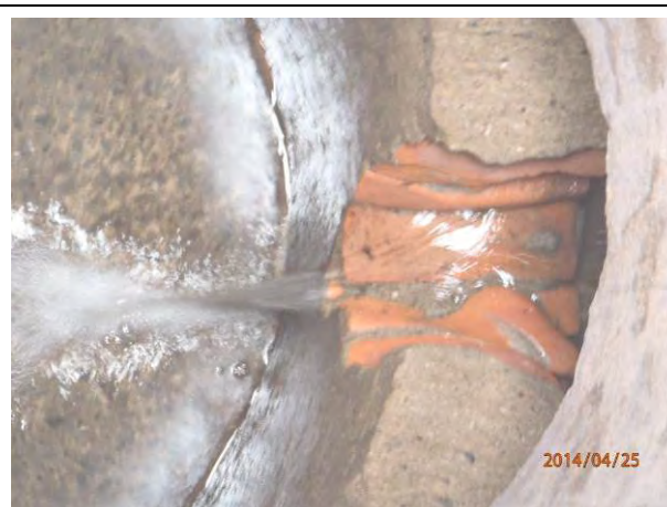
写真 E7. 4: マンホール内も表面のセメント部が浸食され消失している。(2014/4/25)
