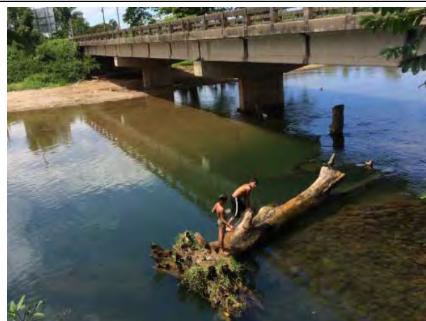
写真 H8.2: トコア橋 桁下空間が小さくなっている。さらに大きな流木が流下する可能性がある。
