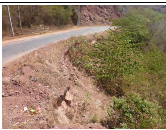
写真 H1.6：地すべり頭部の状況 地すべりが後退した場合道路がさらに被災する。(2015/3/6)
