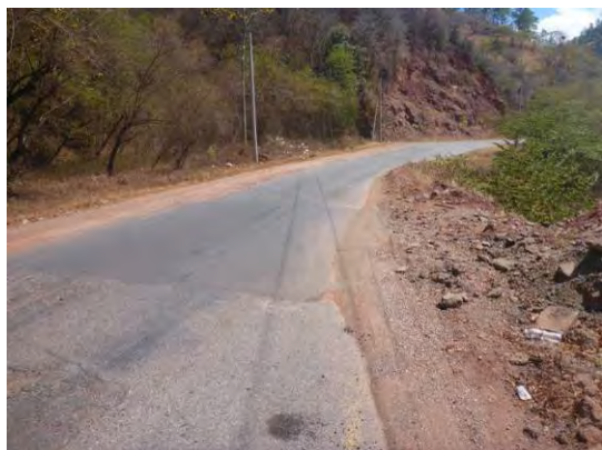
写真 H1.1：路面の状況 地すべりにより道路延長 35mに渡り幅員が 1m 程度狭くなっている。(2015/3/6)
