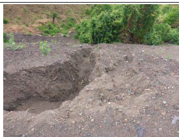
写真 E4. 8: 堰堤に発生しているガリ 斜面勾配が急すぎるものと判断できる (2015/3/25)
