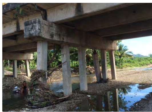
写真 H7.4: ペリス橋 橋脚の杭1本が損壊し流出している。急流部では巨石等の衝突で損壊するケースが多い。強固なコンクリート橋脚に変更する。
