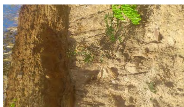
写真 E5.9: 斜面5 斜面頭部のオーバーハング (2015/3/14)
