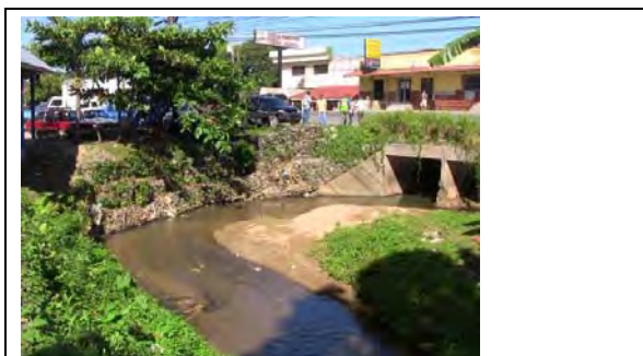
写真 4.4.17: アダン川(ラ・セイバ市)と国道13号線との交差点、河道の湾曲とボックスカルバートの流下能力不足有
