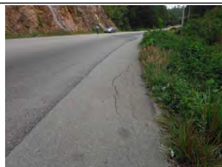
写真 4.4.5: CA-6 Sta. 22+000 地すべりの頭部路面の沈下と亀裂
