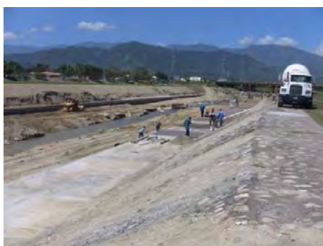
写真 4.4.10: 橋梁付近の河床低下への緊急対策工事 (CA-5 橋梁～鉄道橋区間)
