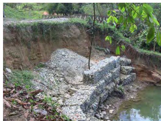
写真 4.4.20: リーン川 (アリゾナ市)、地方自治体管理の道路での河岸侵食と市による応急処置
