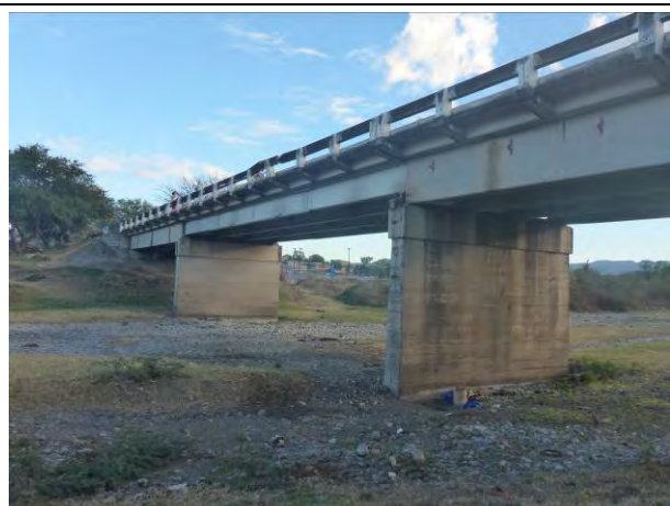
写真 4.3.11: Las Chanillas Bridge 浸食等の進行 は認められなかった (2015/2/26)
