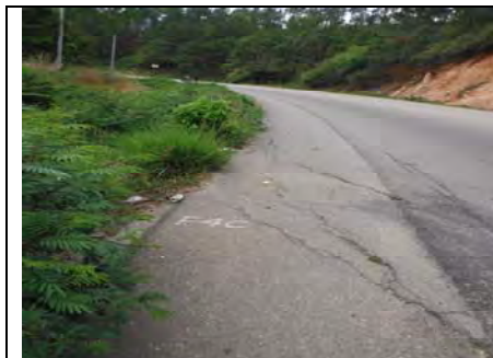
写真 4.4.6: 同左 テグシガルパ側の頭部路面の沈下と亀裂
