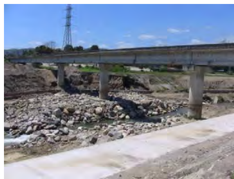
写真 4.4.9: チョロマ川の鉄道橋、2002 年 JICA 無償資金協力により建設 撮影: JICA 調査団 2015 年 3 月
