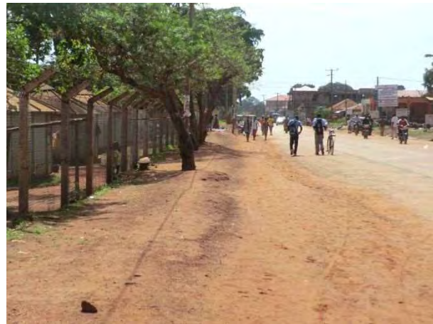
写真 4 : No.2 Acholi Rd. 歩道舗装がなく、側溝も整備されていないため、車 道舗装の劣化が進行する。本路線に USMID の主要 幹線道路（4 車線＋両側停車帯）が接続する
