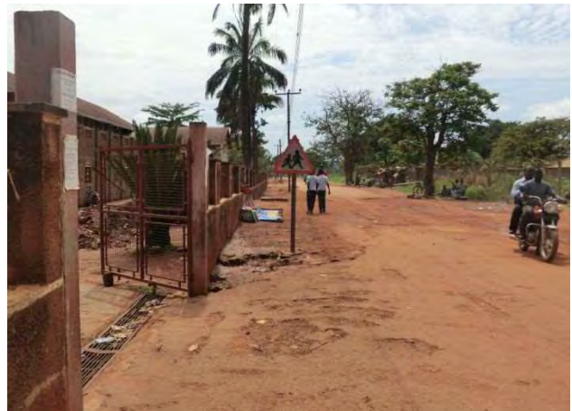
写真 28：路線 No.17 Jomo Kenyatta Rd. 都市部区間と郊外区間の境界部。雨水は右側から流れてくるが、受ける側溝がないため、車道上を溢れている。
