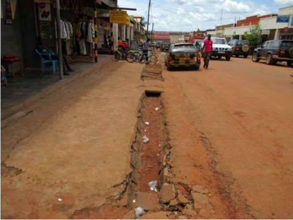
写真 25：路線 No.14 Oliya Rd. 中心市街地の路線の一つ。他路線と同様に側溝機能が失われており、大雨の時は道路上を雨水が走る
