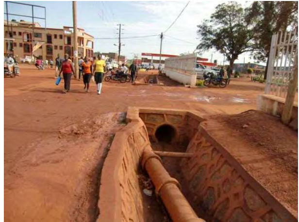
写真 2 : No.1 Kampala Rd. 埋設物が露出しており、浅い位置に埋設されている。 水道管は KfW の支援により移設予定。
