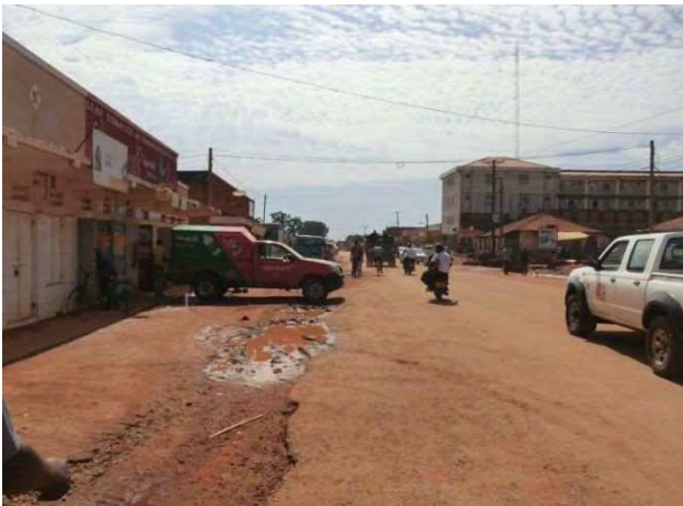
写真 3 : No.2 Acholi Rd. 道路端に側溝がないため、雨水が道路上に帯水し、 路盤に入り込んで舗装が劣化する
