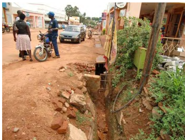
写真 20：路線 No.9 Queens Ave. 側溝の水の流れる先が明確ではなく、加えて電線ケーブルが露出しているなど、危険な状況
