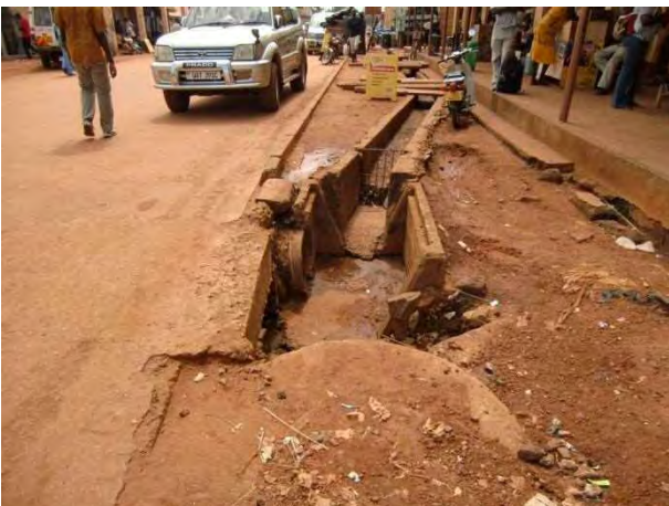
写真 29：路線 No.17 Jomo Kenyatta Rd. No.17 の都市部区間。雨水がうまく横断管と接続されておらず、水が歩道上に溢れて舗装の劣化が進行したと思われる。
