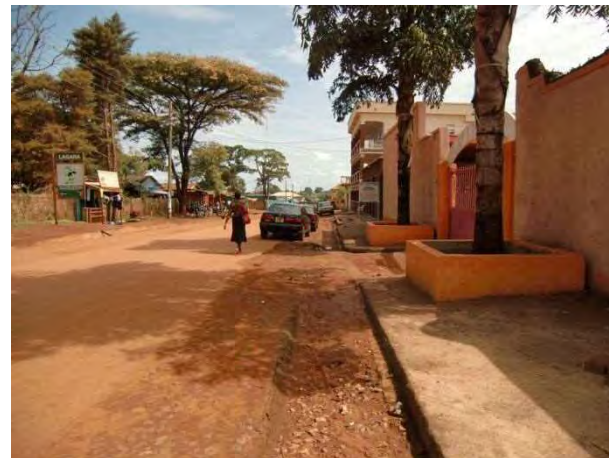
写真 6 : No.3 Lagara Rd. こちら側の側溝は埋まってしまっており、雨期前に 土砂を取り除かないと急速に道路舗装が劣化する
