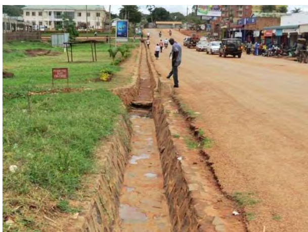
写真 24：路線 No.13 Awere Rd. /Dr. Corti Lucile Road PECE 川を渡河する路線であり、増水すると越流することもある。越流時は通行不可になる
