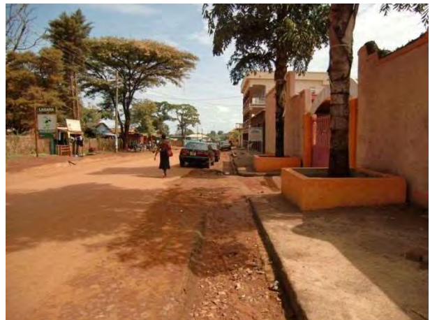
写真 6 : No.3 Lagara Rd. こちら側の側溝は埋まってしまっており、雨期前に 土砂を取り除かないと急速に道路舗装が劣化する
