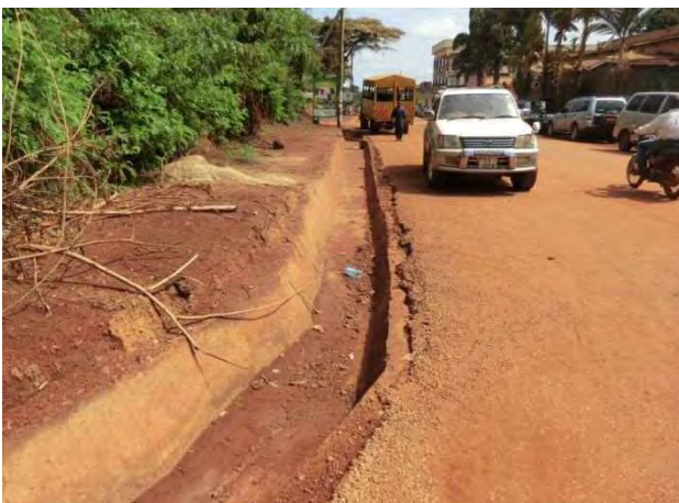
写真 5 : No.3 Lagara Rd. 中心市街地の路線の一つである。側溝が機能してい るため、車道舗装が比較的失われずに残されている
