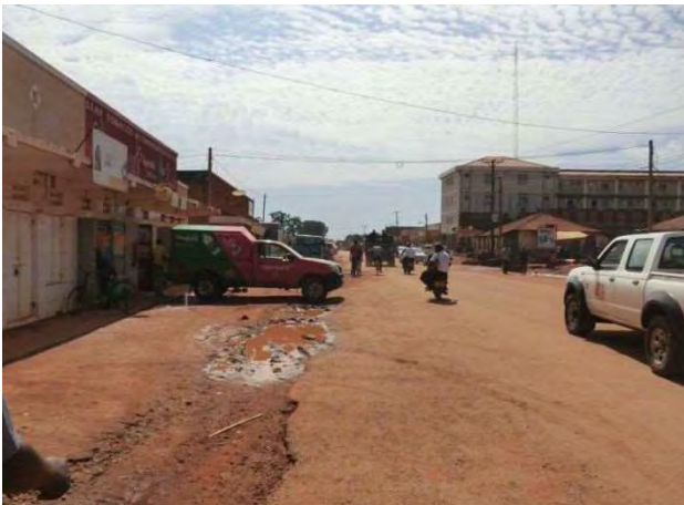
写真 3 : No.2 Acholi Rd. 道路端に側溝がないため、雨水が道路上に帯水し、 路盤に入り込んで舗装が劣化する
