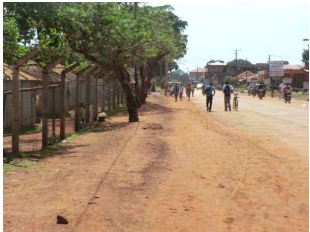
写真 4 : No.2 Acholi Rd. 歩道舗装がなく、側溝も整備されていないため、車 道舗装の劣化が進行する。本路線に USMID の主要 幹線道路（4 車線＋両側停車帯）が接続する
