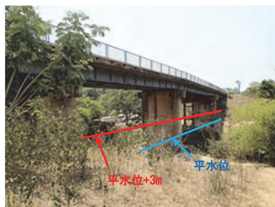
図 2.2.36 ヒアリングによる痕跡水位状況
