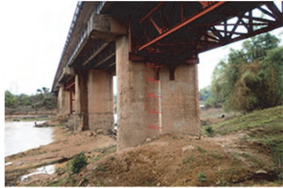
図 2.2.38 目視点検による痕跡水位状況
