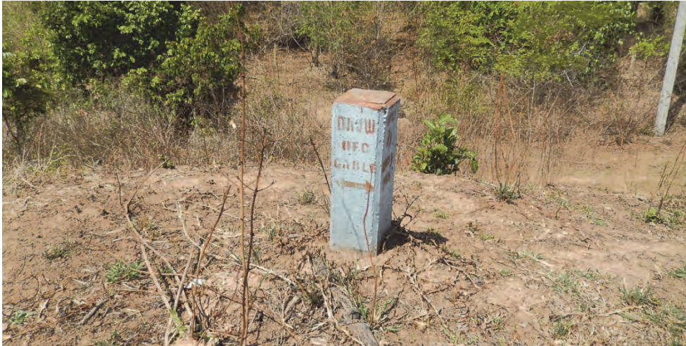
図 2.2.3 セタームアック橋下流側の光ファイバー埋設位置コンクリート杭
