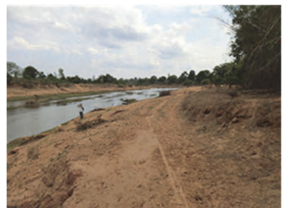
図 2.2.37 下流側河岸状況
