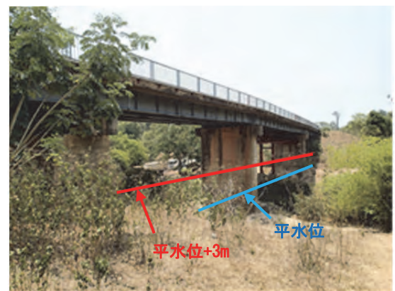
図 2.2.36 ヒアリングによる痕跡水位状況
