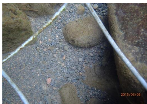
取水口付近に堆積した土砂
