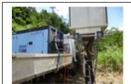
写真 16: 逆洗を行うコンプレッサー
