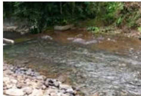
既設取水口側に水が集中して流れるよう流路を確保した。 写真 13: メンテナンス終了後の様子
