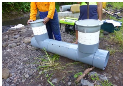
改良版の取水口（配管）
