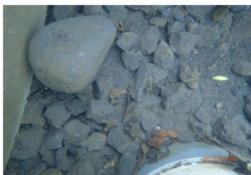
取水口柵に堆積した砂
