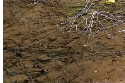
写真 11: 6 ヶ月後 (土砂の堆積を確認)
