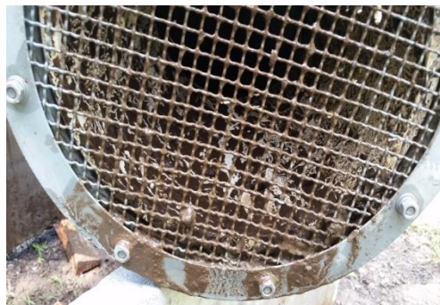
小水力発電取水管の目詰まりの様子
