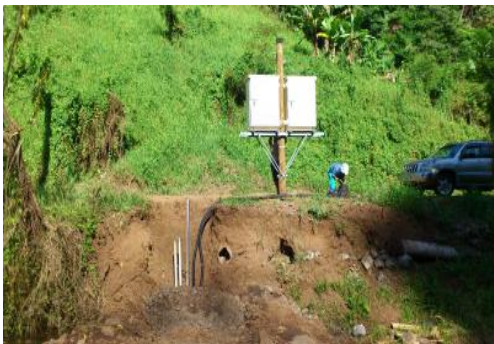
流量計室から既存メイン導水管との 接合升への新設導水管の様子
