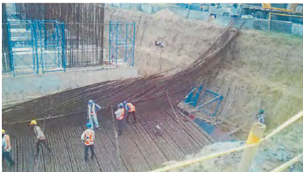
図 4.3.1 強風で倒壊した橋台盾壁の鉛直鉄筋
