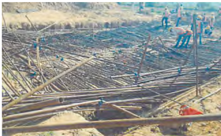
図 4.3.6 強風により倒壊した鉛直鉄筋
