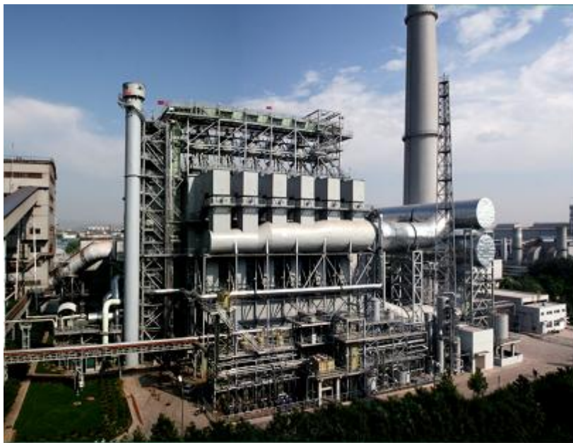
照片 1 干法脱硫脱硝装置全景
