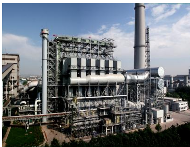
写真 1 乾式脱硫脱硝装置全景
