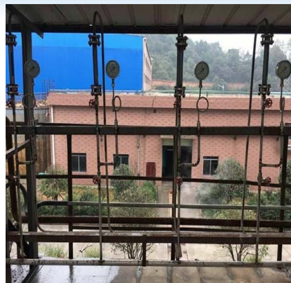
脱硝装置: 流量調整器
