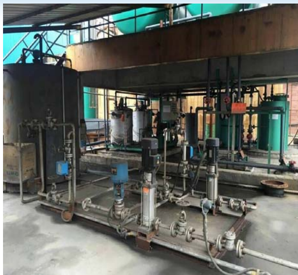
SNCRアンモニア脱 硝施設
