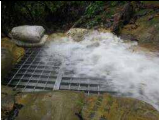
水力発電の取水口(試運転時) (2015年3月)
