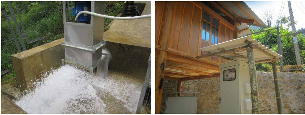
図 23 機器写真 (左 下流のベトナム製1軸水車 右 ベトナム製発電制御盤)
