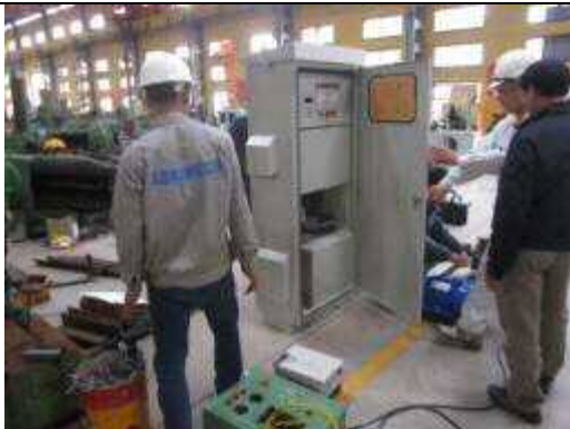
水力発電機の制御盤の技術指導 (2014年11月)
