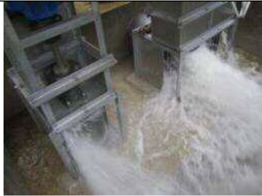
水力発電機の試運転 (2015年3月)
