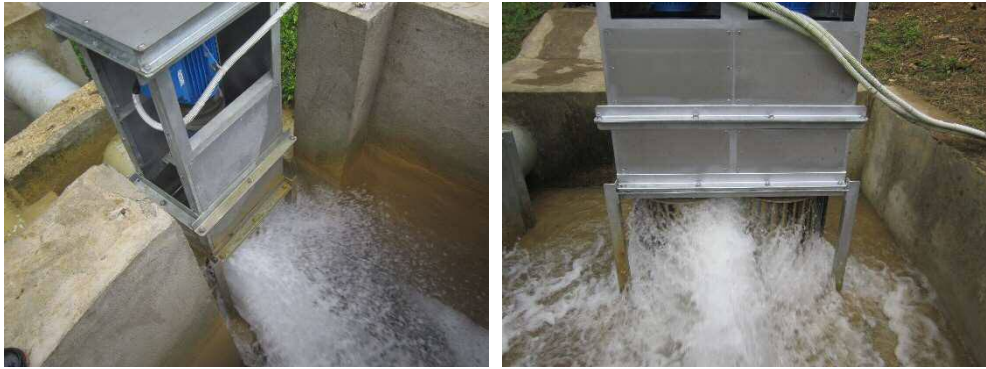
図 22 機器写真 (左 上流の日本製1軸水車 右 下流のベトナム製2軸水車)
