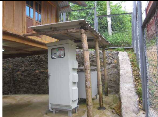
発電制御盤 (2015年9月)
