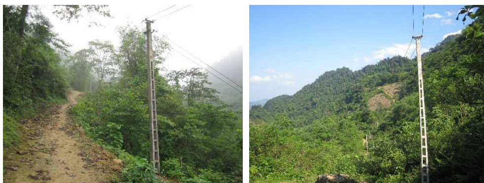
図 26 各世帯へ送電するための電柱
