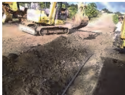
浸出水循環ポンプのための地下埋設電気配管
