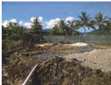
設置された浸出水処理プロセス (2014 年 9 月)
