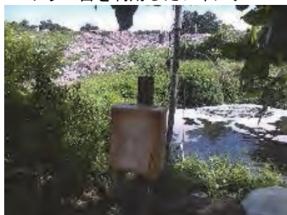
浸出水循環ポンプ用の電気中継ボックス
