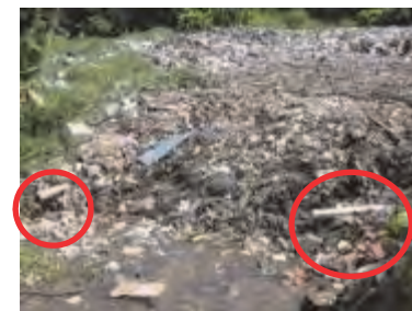
既存と新しい浸出水のパイプ
