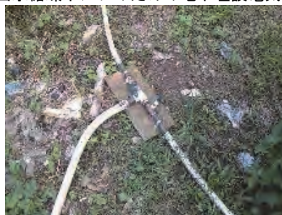
浸出水循環用配管の切り替えコック
