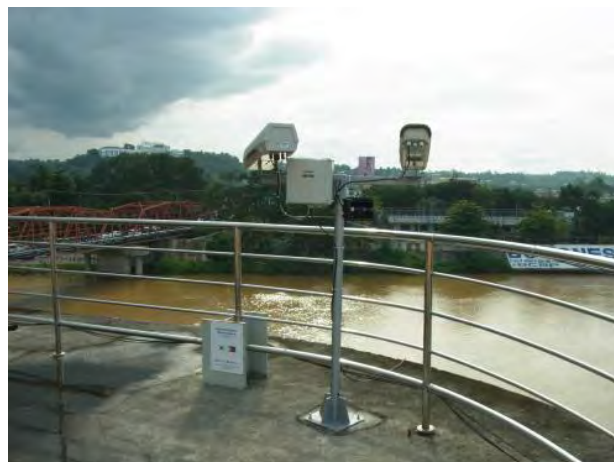
カガヤン・デ・オロ川監視システム (CCTV)
