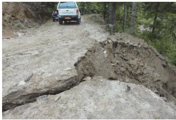
農村道路（ブムタン県） 排水側溝が十分でなく排水が路面を通過し、 谷側路肩が崩壊した
