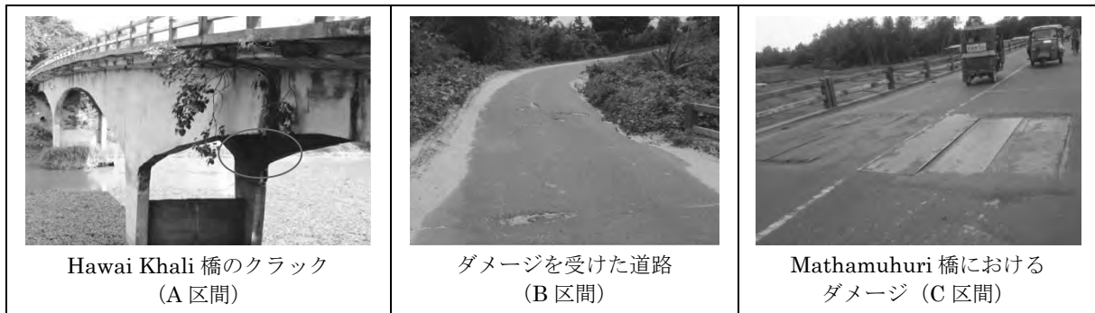
図 3.3.3 ダメージを受けた橋および道路の写真
