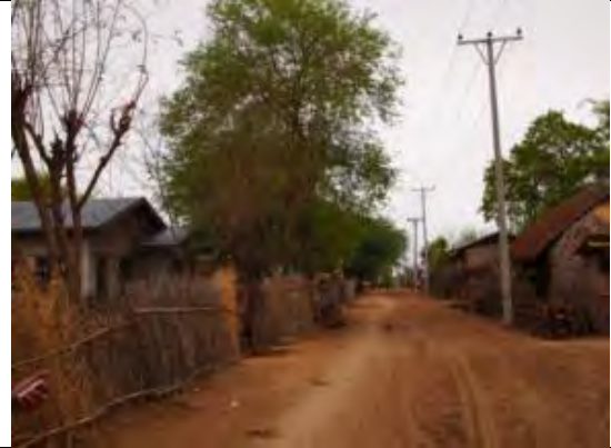
写真-8: 村落における電線整備状況 (Mahlaing タウンシップ Asone村)
