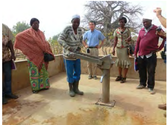
写真-2 日本の無償資金協力による人力ポンプ
