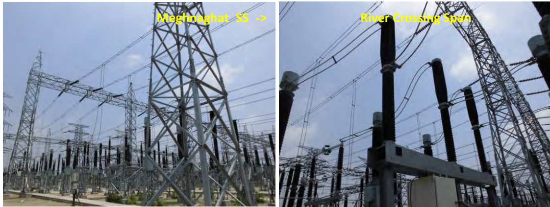
(a) 既設 230 kV 気中開閉設備
