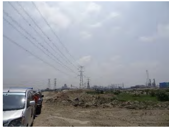
既設 230 kV Meghnaghat 変電所
