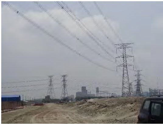
400 kV Meghnaghat 変電所サイト
