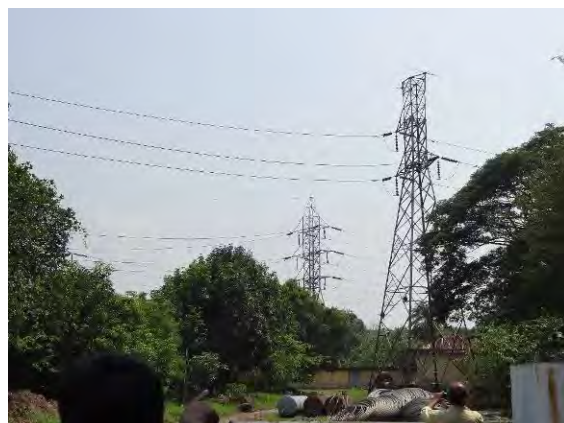
Madunaghat 変電所内既設 132 kV 送電線
