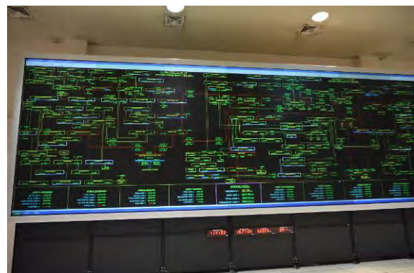
給電系統監視盤
