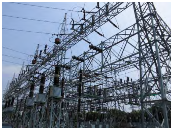
(a) 既設 132 kV 気中絶縁開閉設備
