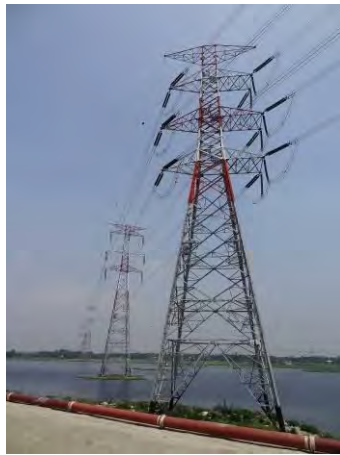
230 kV Meghnaghat – Aminbazar 送電線 (400 kV 設計)
