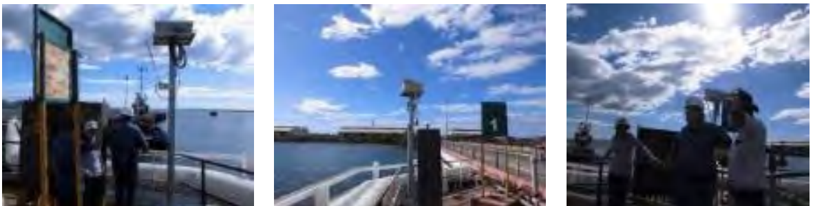
図 2.6.11 潮位計 北西側から(左)、東側から(中)、北東側から(右)
