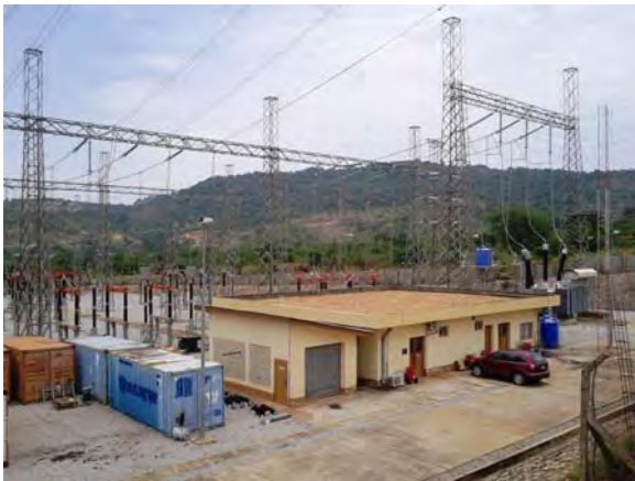
330/132/33kV カタンペ変電所の様子
