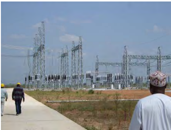
330/132/33kV グワグワラダ変電所の様子
