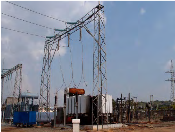
132/33 kV アポ変電所構内にある焼失した変圧器
