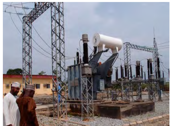
132/33 kV ケフィ変電所
