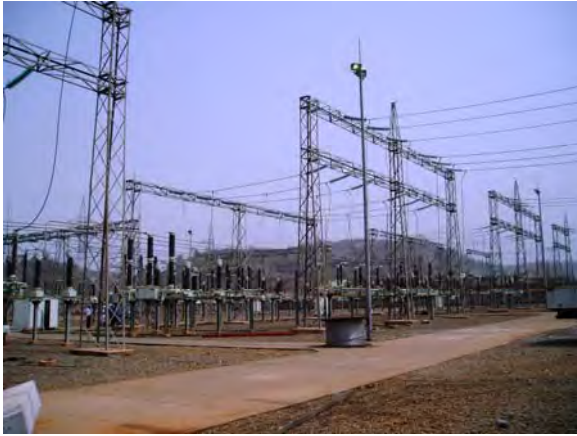
132/33 kV アポ変電所の様子
