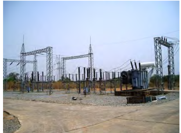
132/33 kV ケフィ変電所の様子
