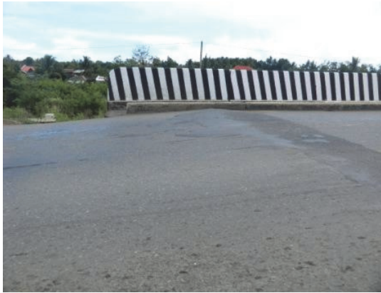
同上 取り付け部が沈下しているため、大きな段差が生じている。
