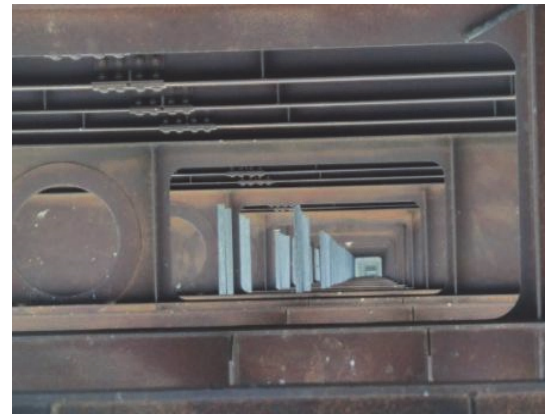
同左 点検用通路のレール、支柱が盗まれ点検ができない。
