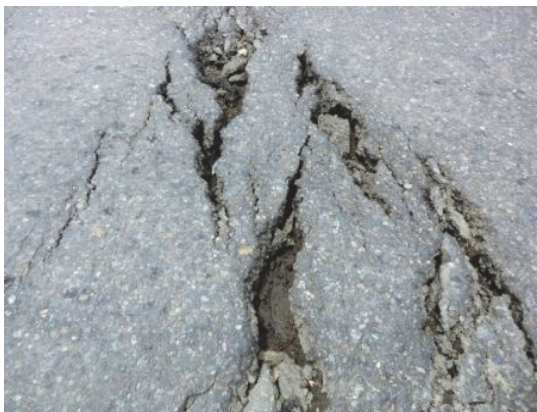
同上 舗装クラック、わだちぼれにより、鋼床版が露出してしまっている。
