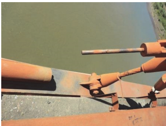
同左 センターステイが破損している。
