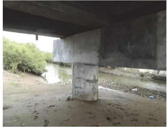
同左。橋脚部、柱を巻きたて補修し、リチウムを塗布して塩害防止を図っている。
