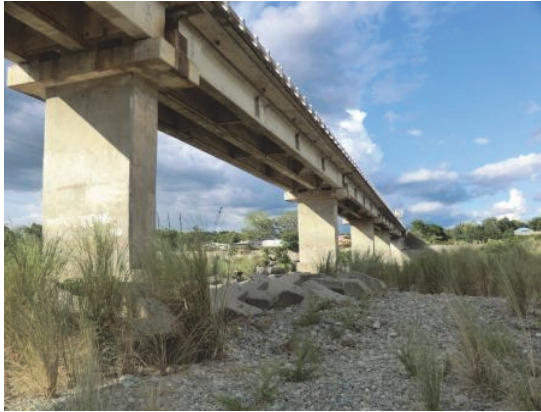
Pinacanauan Bridge (PC 橋) 日本の援助により建設された。PC 橋であることからほとんど損傷は見られない。
