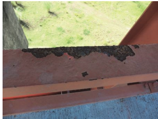
十分な下地処理が行われていなかったため、再塗装したにもかかわらず、錆が発生している。
