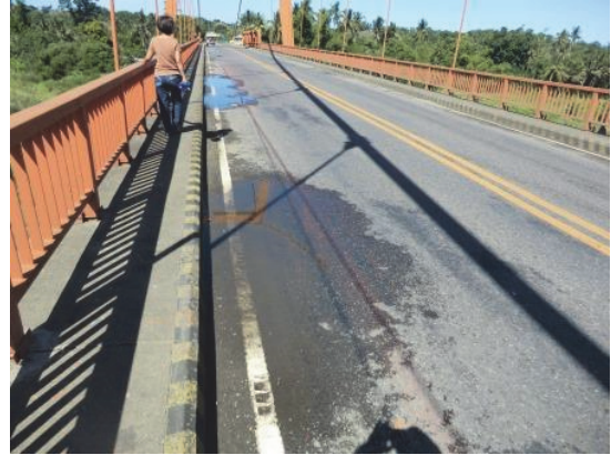
同左 排水溝を舗装で埋めてしまい、路面に水がたまり、コンクリート床版に悪影響を及ぼしている。
