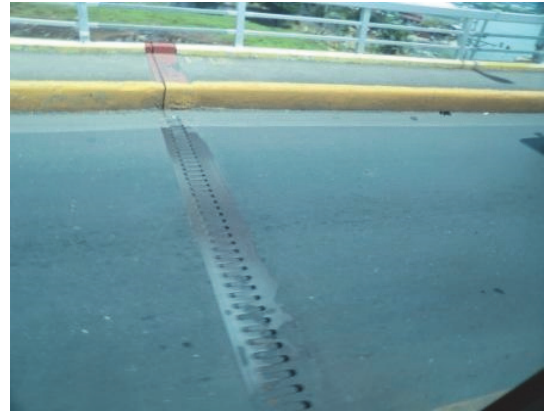
同上 アスファルト路面は、毎年補修されている。
