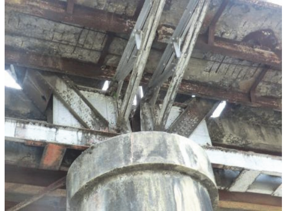
同左 歩道部分は床版コンクリートの損傷が激しく鉄筋露出、コンクリート剥離が発生している。
