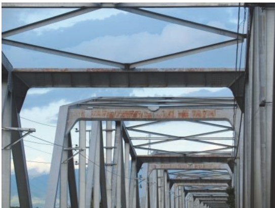
トラス下主構の一部は錆びているが構造上問題ない。
