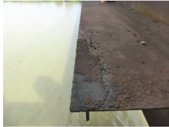
同左 耐候性鋼板を使用しているが、常に水があたる部分は、不安定錆が生じている。(フェアリング部)
