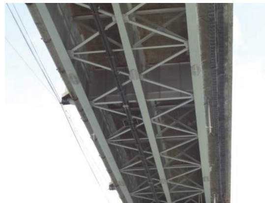
同左 コンクリート床版にはクラック、漏水が見られる。近々、DPWH、RO VIIにおいて補修工事实施予定。
