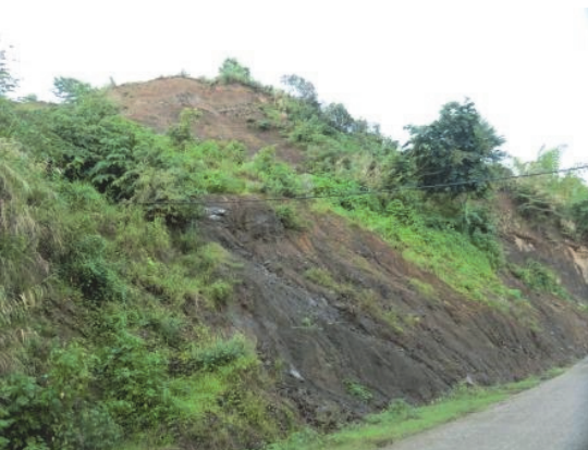
斜面上部が土砂崩落している。
