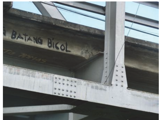
コンクリート床版の一部が、剥離している。
