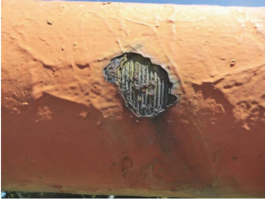
同上 再塗装したにもかかわらず、塗膜が剥がれ再び錆が発生している。
