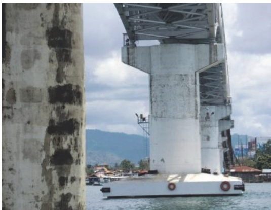
第1 マンダウエ・マクタン橋 海水により、基礎下面の損傷が激しいP8 橋脚。
