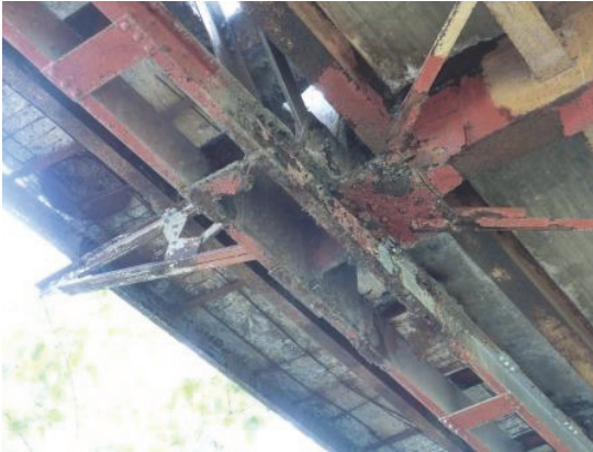
トラス下主構の一部は錆びて断面欠損している。
