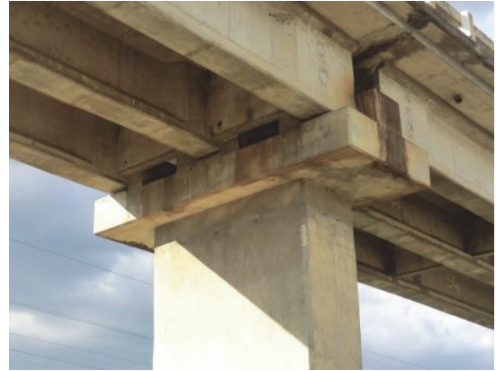
同左 伸縮装置が設置されていないため、路面からの雨水等が橋脚に垂れ流しされている。
