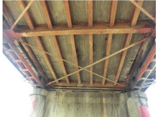
トラス主構、縦桁、横桁とも塗装は剥がれ錆びているがおおむね健全である。
