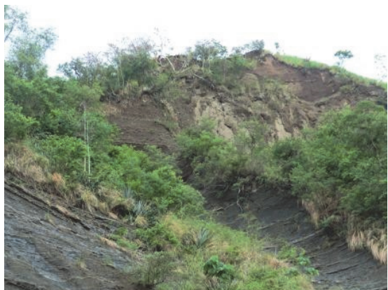
同左 山の頂部から斜面崩壊が発生している。
