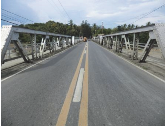
Tumagbok Bridge（トラス橋。1928年建設されたトラス橋である。主構造は一部錆びているが橋全体の構造はおおむね健全である。
