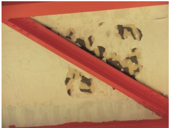
コンクリート床版下面をグラスファイバーにより補修したが、既に剥がれが発生している。
