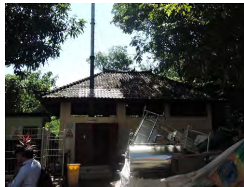
Wangaya 病院の医療廃棄物焼却設備
