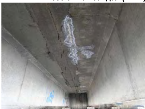
Фото 2.4.48 Хучилтын хавтанг хүчитгэхээс өмнөх байдал (ID-41)
