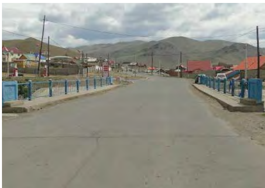
Фото 2.4.44 Засвар хүчитгэл хийхээс өмнө (Гүүрийн хэсэг; ID-41)
