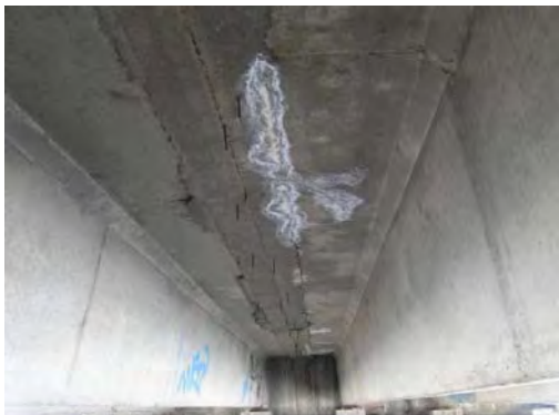
写真 2.4.48 床版補強前(ID-41)
