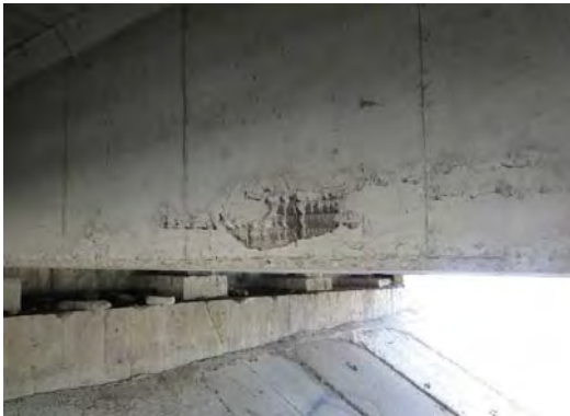
写真 2.4.46 断面修復前(ID-41)
