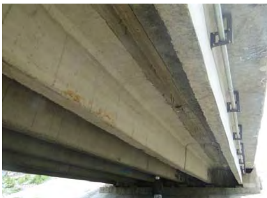
写真 2.4.50 主桁補強前(ID-41)
