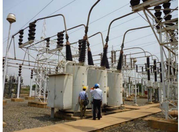
既存のアチモタ境界変電所(変電容量:330 MVA)
