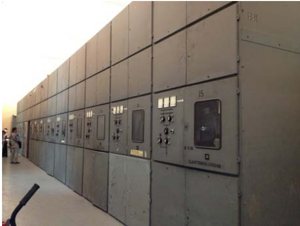
グラフィックロード一次変電所の既存の 33 kV 開閉設備
