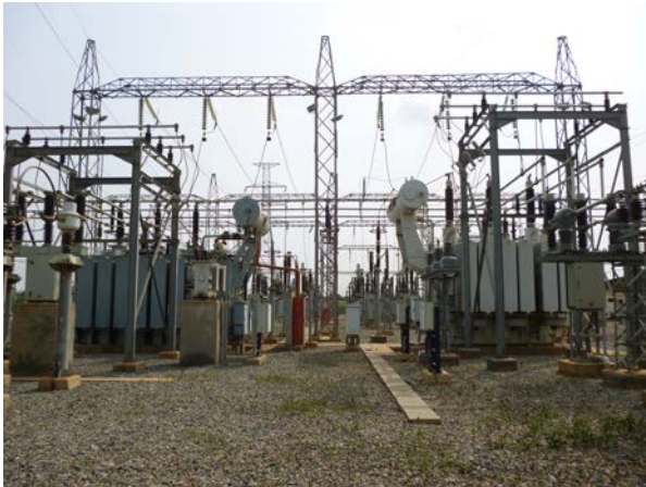
既存のマラン境界変電所(変電容量:264 MVA)
