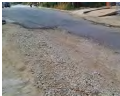
(1) Quốc lộ số 20 (đoạn Đà Lạt – Đ'ran) Đoạn chưa được duy tu rất hẹp, bề rộng chỉ có 3,5m
