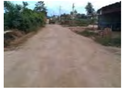
③ Huyện lộ (Phú Hội - Da Quy) khu vực phía sau KCN, đường đất, đi lại rất khó khăn
