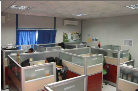
写真-11：仮設建物を使用している職員棟。動くとき床が大きくたわむ。地震等の自然災害で損傷する危険性がある。
