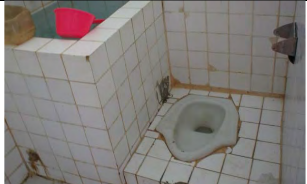
写真-10：教室棟女子便所。2階の女子便所は故障しており使用できない。
