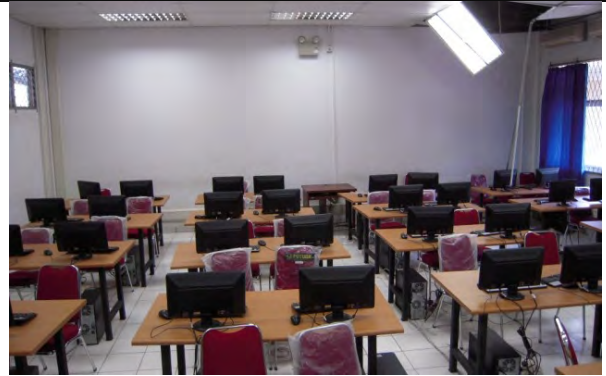
写真-8：コンピュータ室。天井が一部崩壊しており、照明器具が落下する恐れがある。
