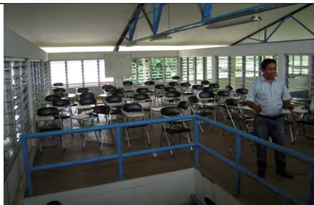
写真-4：土木学科ワークショップ棟。ロフト空間を教室利用している。周囲の騒音等が反響して教室として不適。規模的に不足している。
