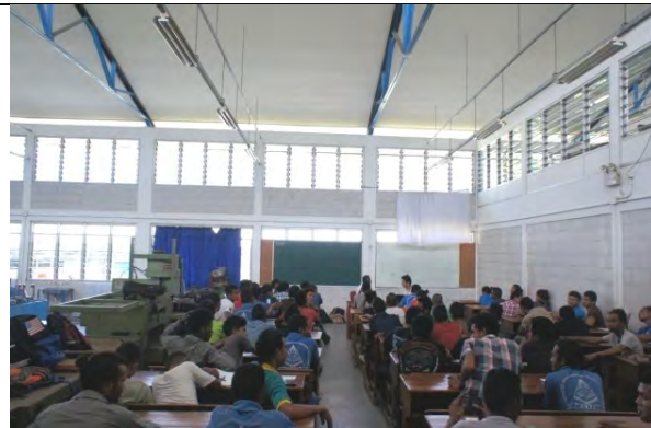
写真-5：土木学科ワークショップ棟。実習スペースであった空間を教室として利用している。教室と実習スペースを隔てる壁がない。実習の騒音等で授業に集中できる環境にない。
