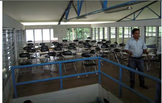
写真-4：土木学科ワークショップ棟。ロフト空間を教室利用している。周囲の騒音等が反響して教室として不適。規模的に不足している。
