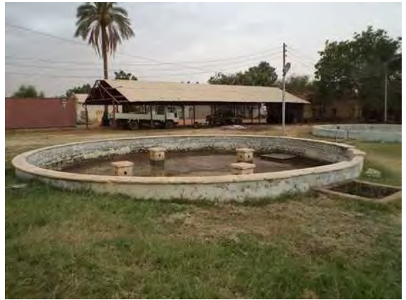
写真 - 8 : 円筒形の浄水池。建設後の地盤面の上昇により、頂版が地盤面より低くなり、雨水等の流入が問題となっている。
