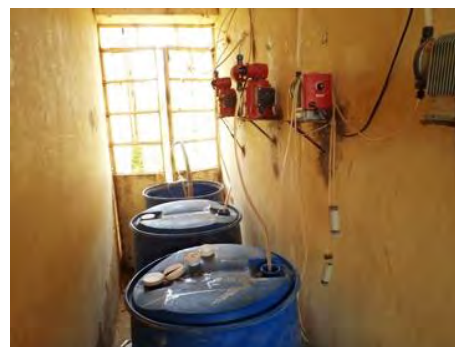
凝集剤注入装置
