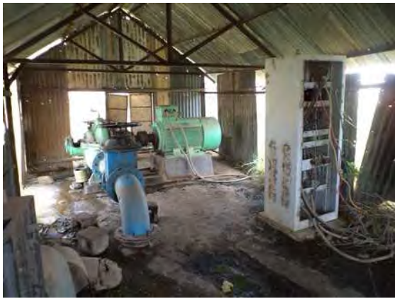
写真 - 9 : 配水ポンプ室。既存浄水場内に3箇所に分けて設置されているが、どれも建屋が簡易なものであり、風雨等の影響を完全に避けることができない。
