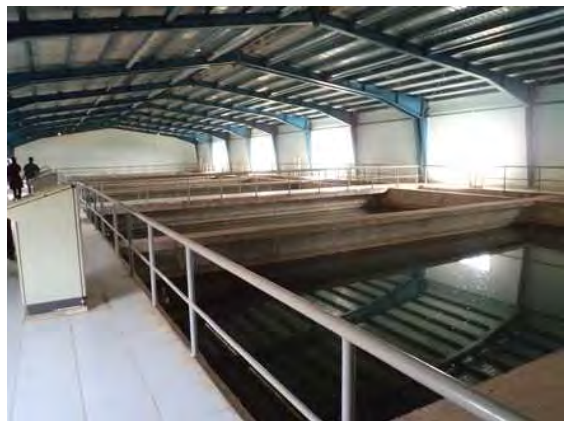
写真 - 12 : イランの有償資金協力により建設されたジャバローリヤ浄水場（ハルツーム州）
