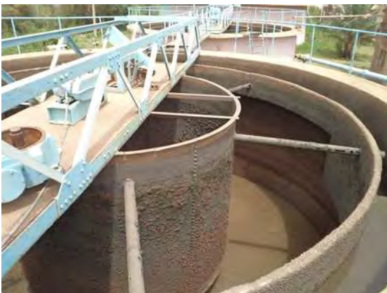
写真 - 5 : 高速凝集沈殿方式を採用している沈殿池。躯体、設備の老朽化が進み、適切に機能していない。
