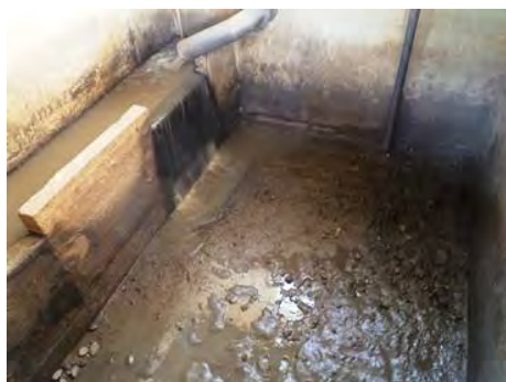
急速ろ過池内部のろ材表面に 堆積している泥
