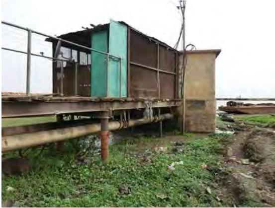
写真 - 1 : 3箇所ある既存取水施設の内、最も古い施設。導水に石綿管が用いられており、激しく漏水している。
