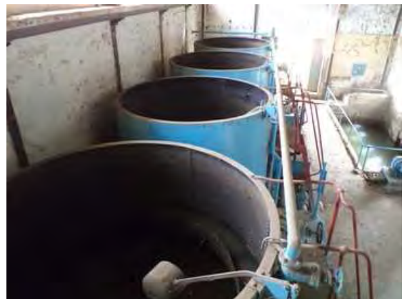
写真 - 6 : 鋼製の急速ろ過システム。建設から70年程度経過しており、躯体の老朽化が著しい。また現状、ろ材の洗浄機能は無い。
