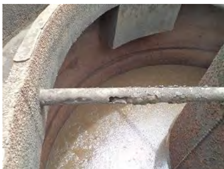
腐食して穴の開いた流出管
