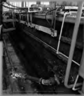
Fugas y derrames
