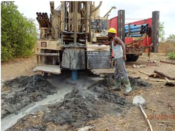
試掘井の掘削状況。対象サイトは基盤岩地帯で地下水開発が難しく、電気探査の結果が良好であっても、実際の試掘では空井戸となる場合も多い。
