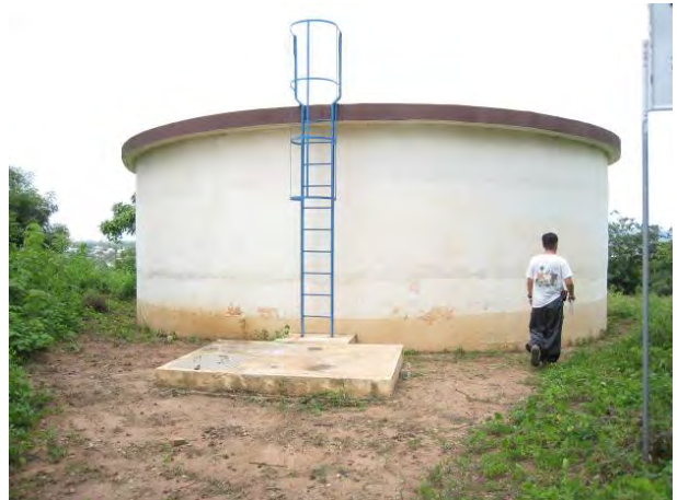
ダッサズメ市の中央を南北に走る残丘の上にある既存配水池（200m 3 ）。グラズエ市の既存高架水槽と同様に圧力調整槽として使用されている。
