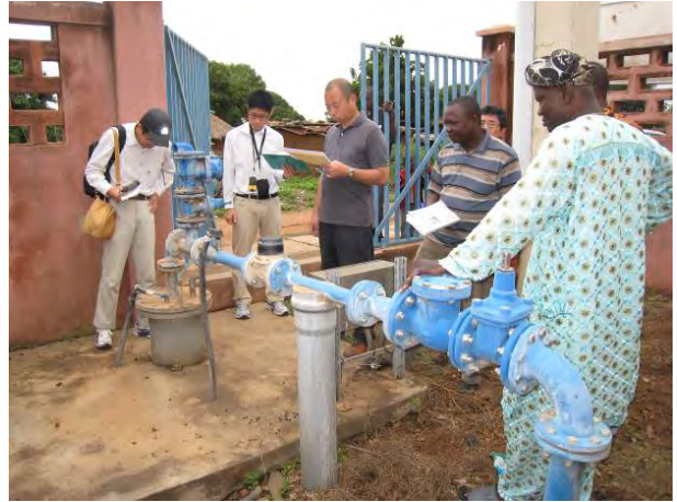
SONEB の既存深井戸（グラズエ市の Ogoudako 井戸）。2009 年にドイツの支援により、既存のハンドポンプ井を都市水道用の水源に改修された。
