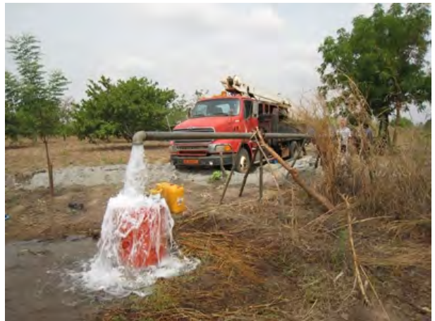
試掘井（3-SE4'）の揚水試験状況。当該地域ではこれまでに開発されたことのない50m 3 /時を超える能力を有する井戸を開発することができた。
