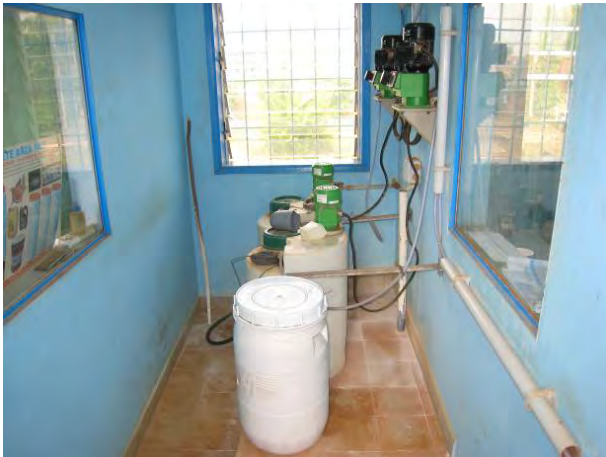
SONEB の既存消毒設備。井戸から取水した地下水にさらし粉の溶液をポンプで圧入して消毒処理を行った後、配水管網に直圧で配水している。
