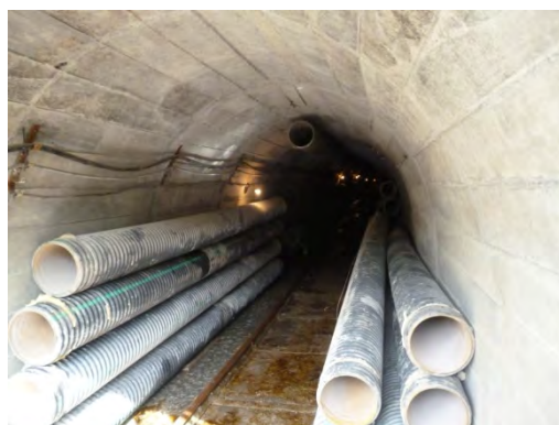
写真 2-5-16 坑内 (換気・照明) 状況 (調査団撮影)
