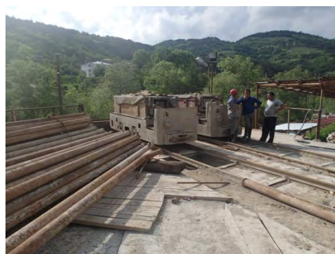
写真 2-5-13 電動トロッコ (調査団撮影)
