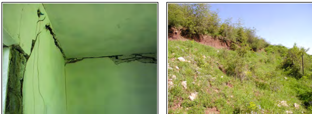
写真 2-5-22 住居の壁に生じた亀裂（左）と地すべりの頭部滑落崖、調査団撮影
