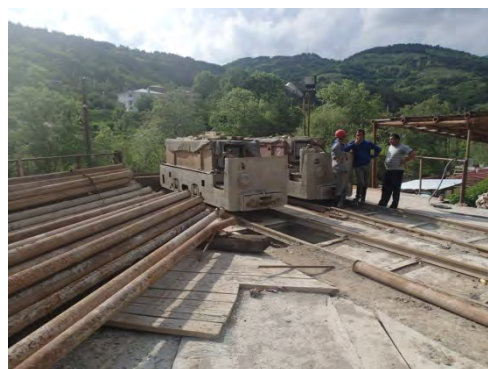
写真 2-5-15 坑口・換気設備 (調査団撮影)
