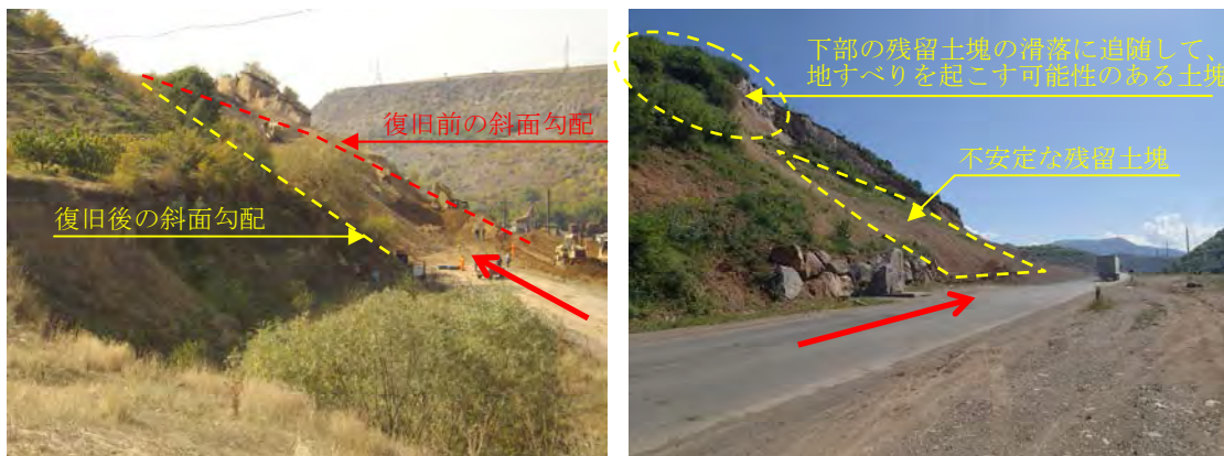
写真 2-5-6 復旧前後の地すべり下部斜面の勾配と不安定化する危険のある土塊（調査団撮影）
