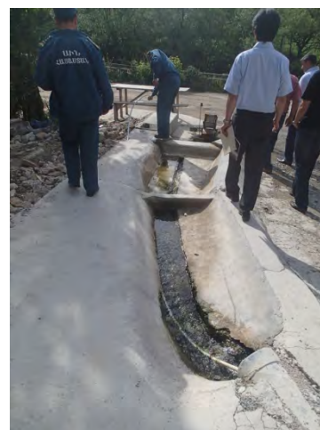
写真 2-5-17 排水処理施設 (調査団撮影)
