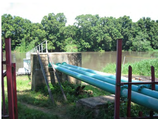
SSUWC ジュバ支所浄水場の取水口
