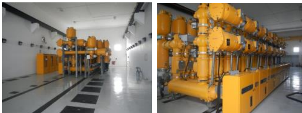
図 5.2-1 屋内型 GIS (ケラワラピティヤ開閉所)
