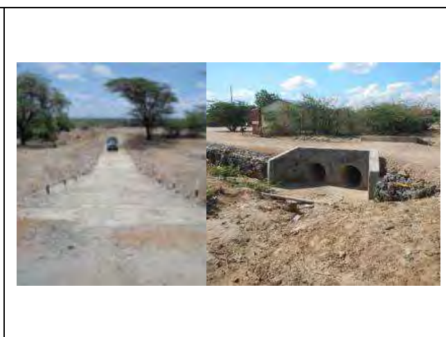
家畜マーケットのための道路改良 - 左: ココピト沈下橋、右: ロドワ家畜マーケットパイプカルバート (トウルカナ県)
