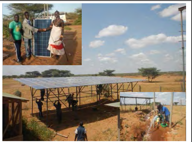
太陽光発電揚水システムの導入 - シュール(マルサビット県)
