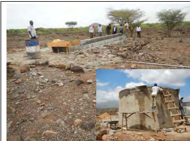
給水パイプラインシステム - アラパル (マルサビット県)
