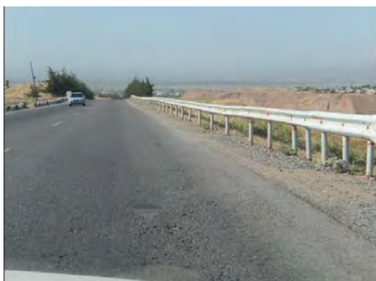
Ограждение типа W-Beam
