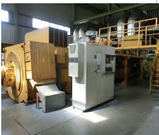
第二建屋発電機
