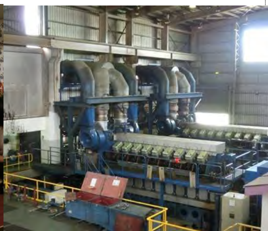
第一建屋発電機
