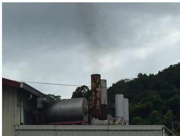
図 5-13 マラカル発電所 14号機、15号機 煙突排煙(黒煙噴出状況)
