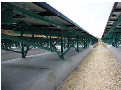
図 3-10 コンクリート平板基礎 (宮古島メガソーラー実証研究設備 PV 基礎)
