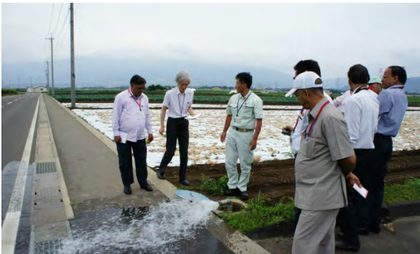
末端灌漑施設 (中信平右岸土地改良区)
