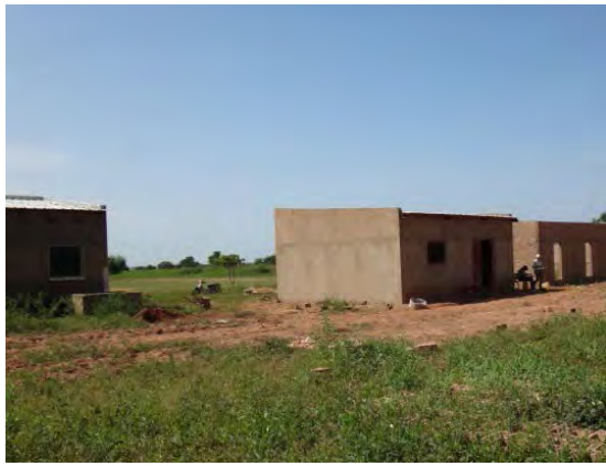
KA-21 : クール セット ジャファー中学校 (ID:39) 写真中央はフランス NGO の援助による 1 教室、右手に建設中の 2 教室 (屋根無し)、校長室、教室と続く。写真左側の建物は隣接する小学校。
