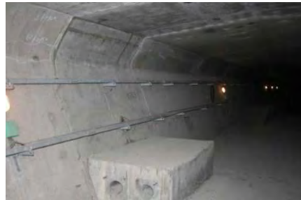
白線は隅角部ハンチに確認されているひび割れ
