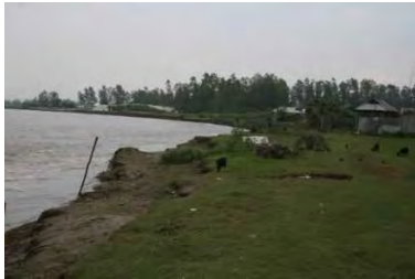
43. 東側ハードポイント上流側の浸食と人家
