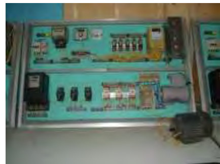
写真.9-4 配電/分電盤装置
