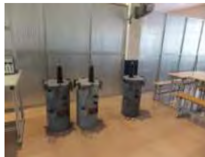
写真.4-2 動力実習室の古いトランス
