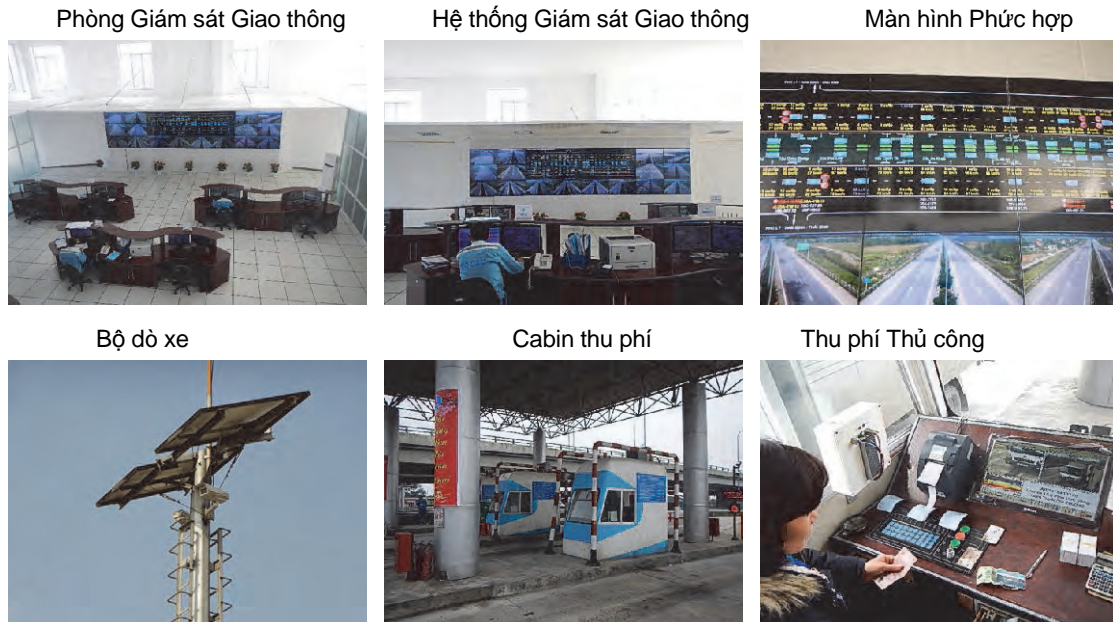
Hình 3.23 Hiện trạng Hệ thống Điều hành Giao thông trên tuyến Cầu Giẽ – Ninh Bình
