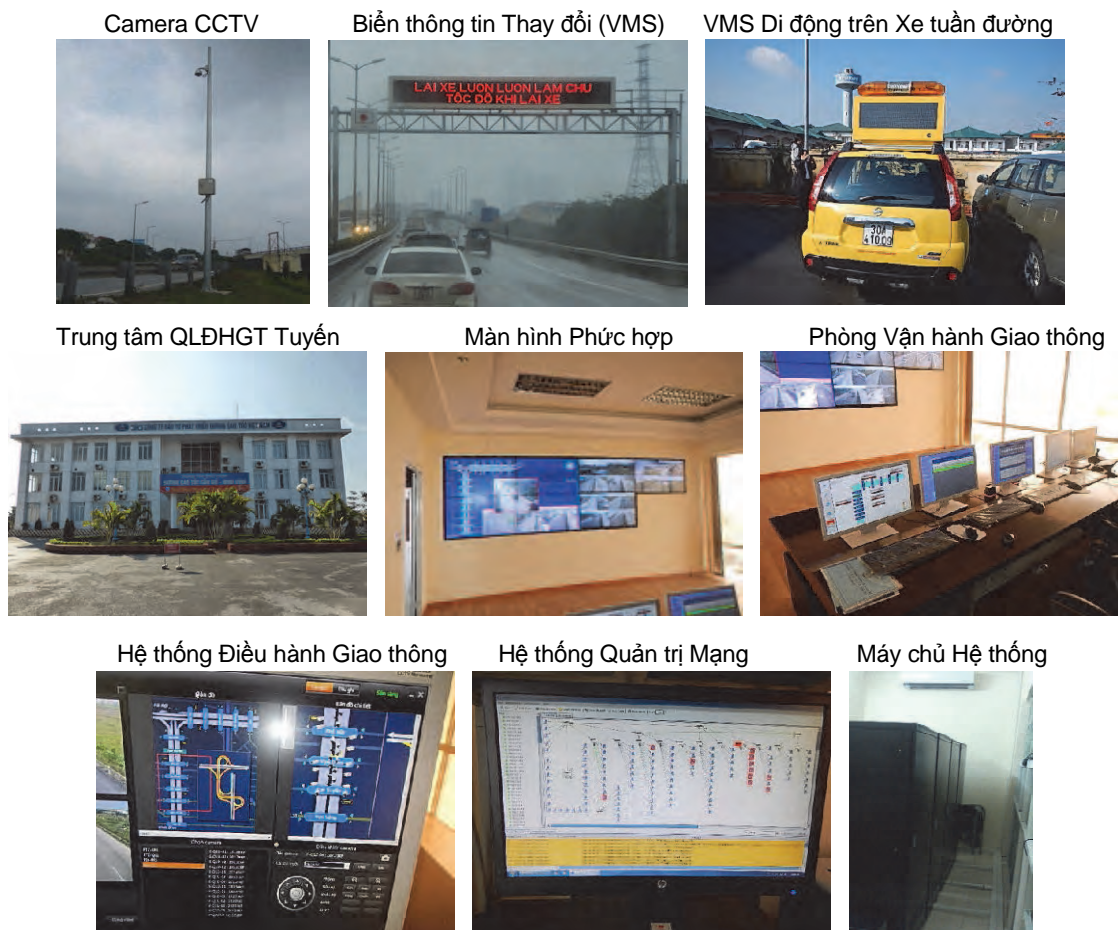
Hình 3.22 Hiện trạng Hệ thống Điều hành Giao thông trên tuyến Pháp Vân – Cầu Giẽ
