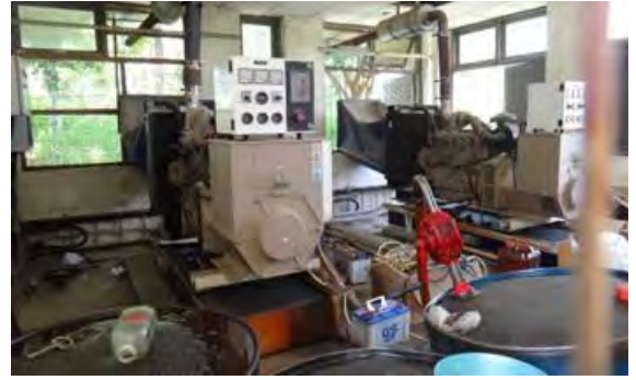
図 5.4-10 非常用発電機
