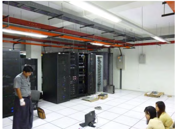
データセンター内観（デッキーナ） 政府や民間企業に対しホスティングサービスとして場所、電源、ネットワーク等の提供を行っている。
