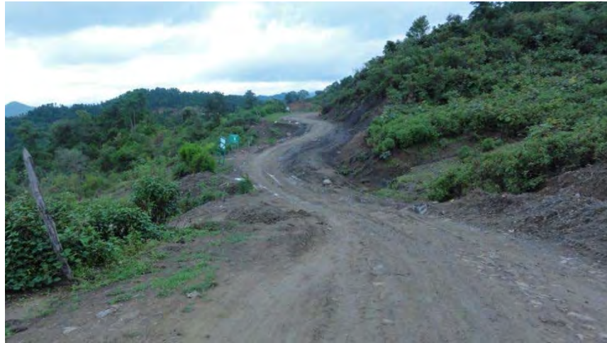
図 4.17 搬入道路（ハッカ～当初予定場所）の被災状況
