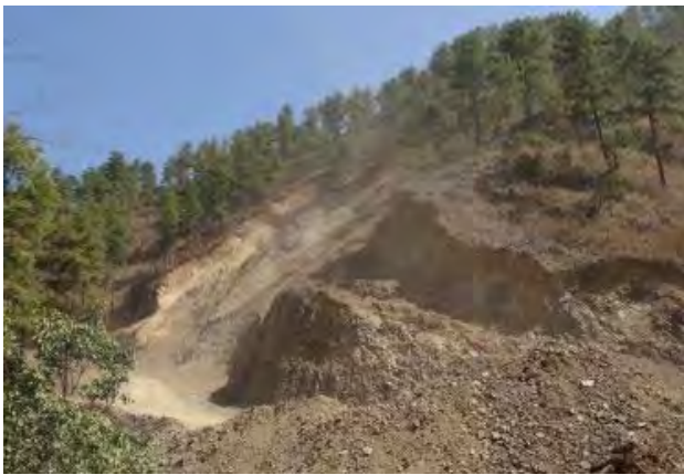
チン州道路拡幅法面の崩壊の様子
