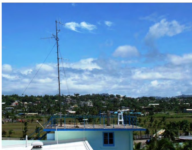
図 3-1-6 水位観測所とのデータ通信用 VHF アンテナ（SUVA 地方気象台）
