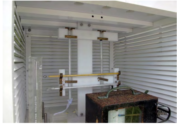
百葉箱の中（相当腐食の進行している測器もある）
