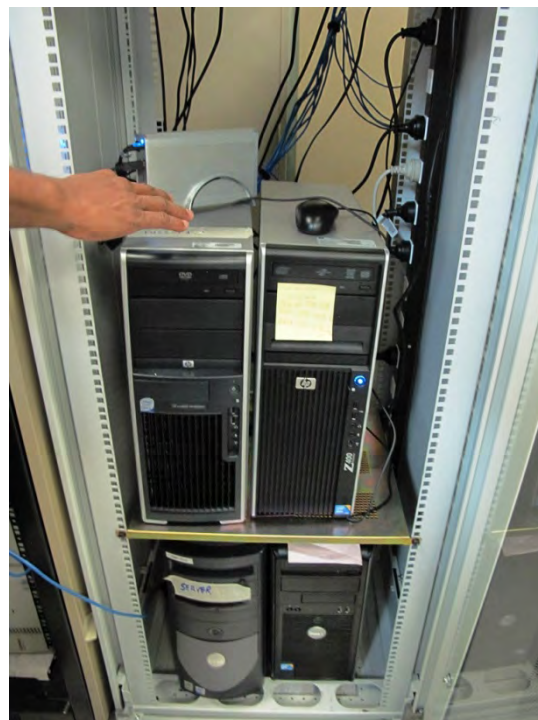
フィジー気象局の GTS/MSS の一部
