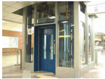
エレベータ（シースルー型）の例
